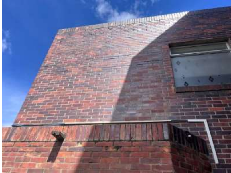
El cableado ubicado en la fachada posterior se encuentra expuesto a la intemperie; la canaleta destinada para su protección presenta ruptura.
