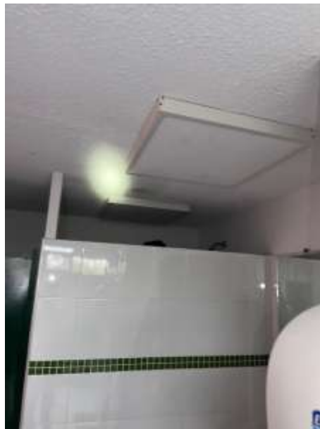
Baño - Luminaria sin funcionamiento
