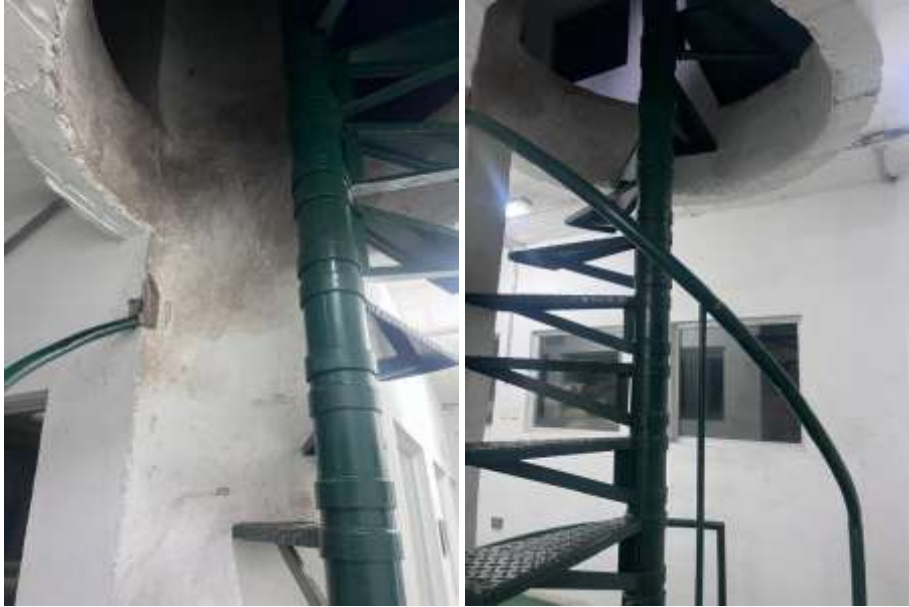
Condiciones de los muros que rondan la escalera Y la escalera de caracol; ambos requieren trabajos de pintura.
