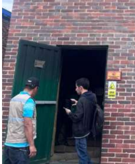
Condiciones actuales de la puerta de acceso principal, evidenciándose deterioro en su estado físico.
