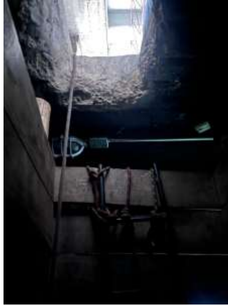
Condiciones actuales de la línea de vida en el interior de la torre, la cual requiere la instalación de anclajes adicionales para el cumplimiento de las condiciones de seguridad.
