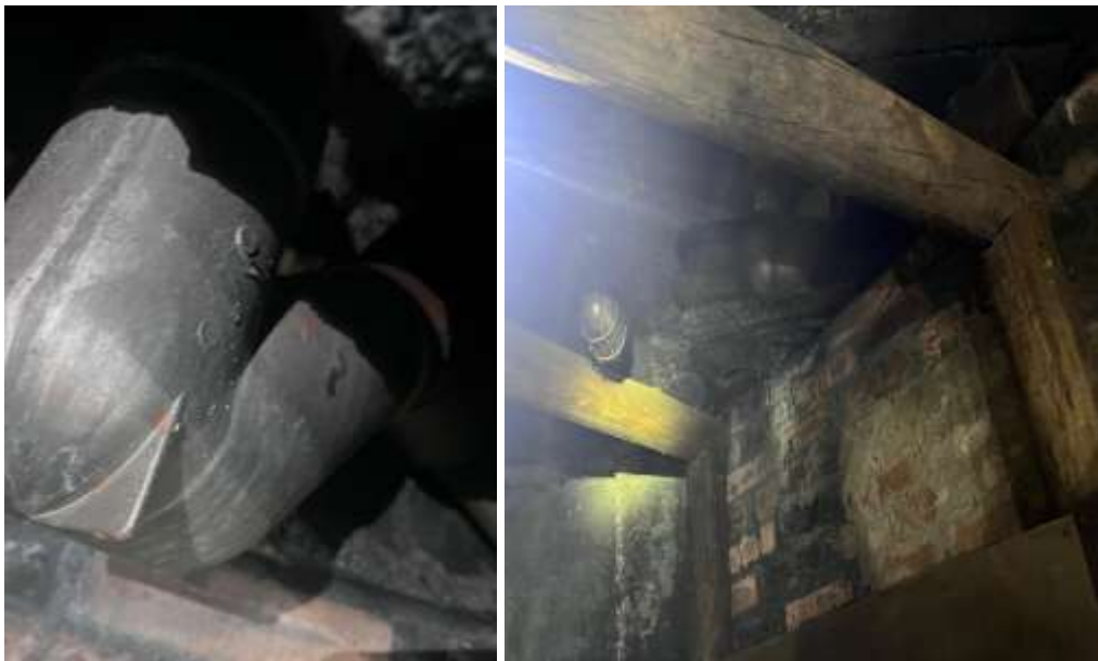
Salida sanitaria con requerimiento de mantenimiento.
