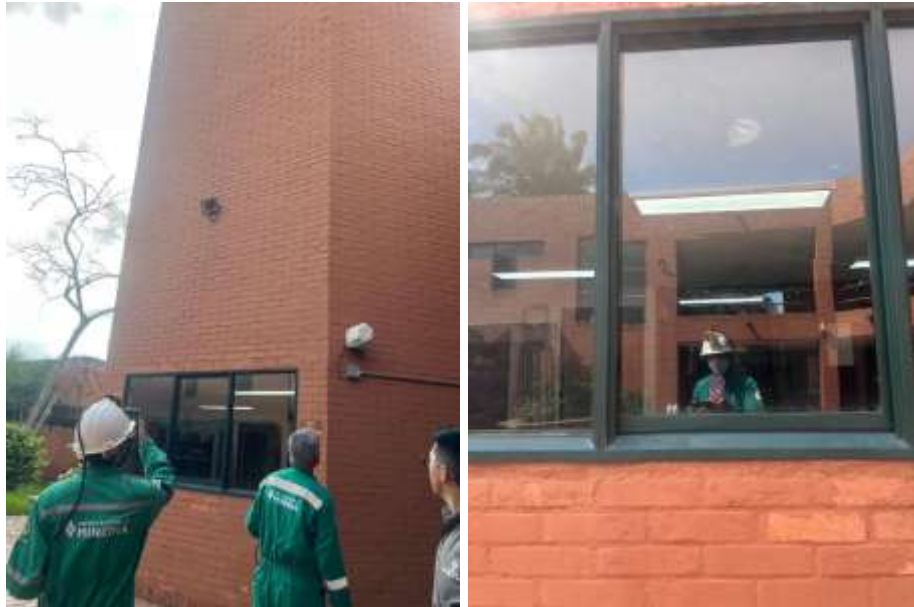
Ventana (vidrio roto) – piso No. 1
