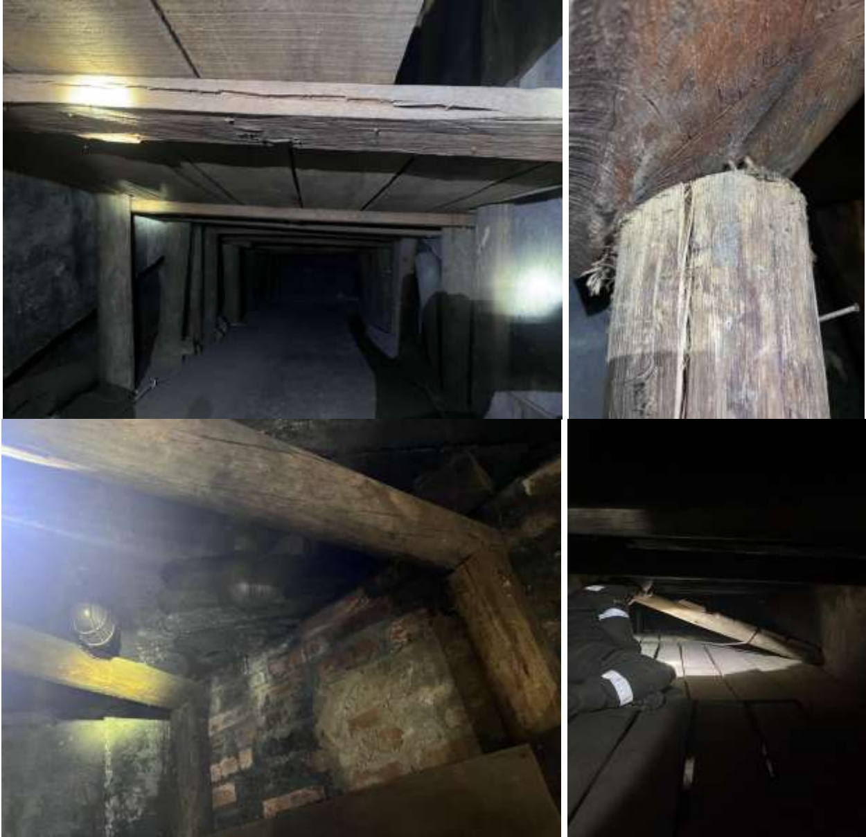
Condiciones actuales de la madera en los obstáculos de entrenamiento.
