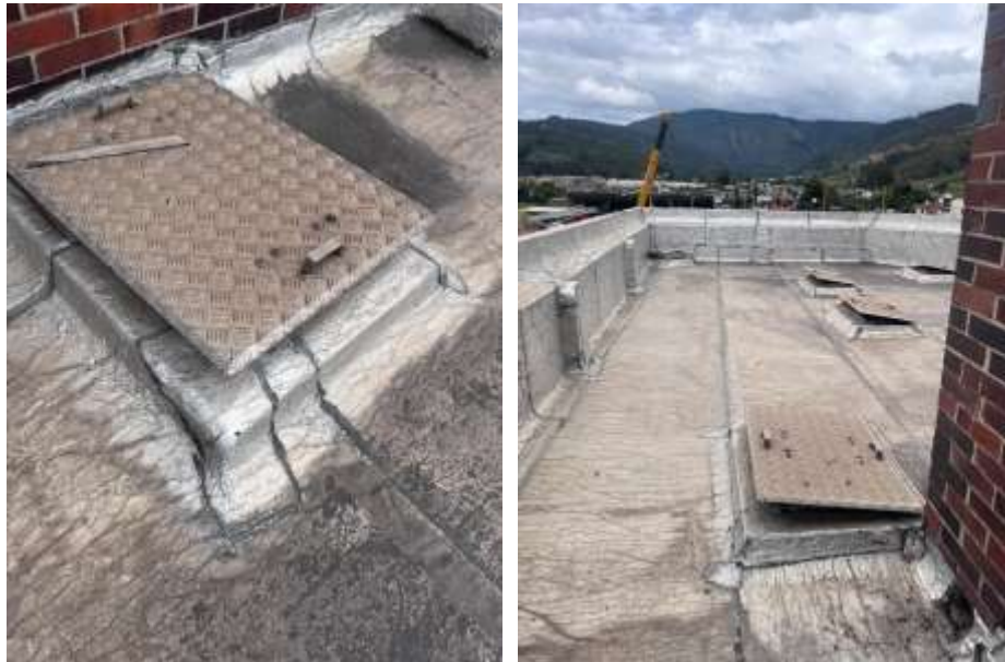
Estado actual de las escotillas en la terraza, las cuales requieren reemplazo
