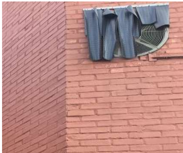
Condiciones del extractor y su protección
