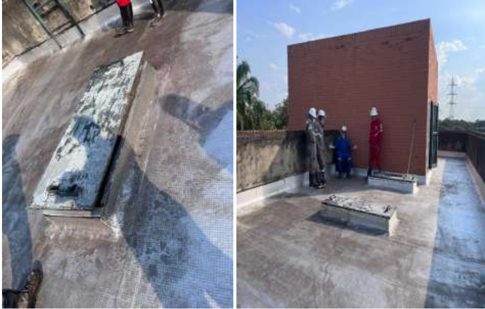
Escotillas en mal estado
