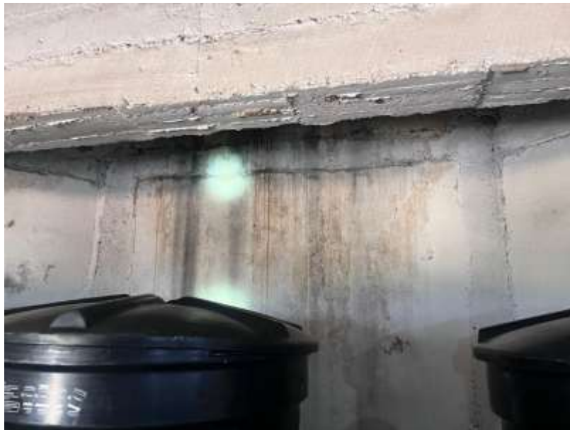
Presencia de filtración de agua en el tejado de la torre.
