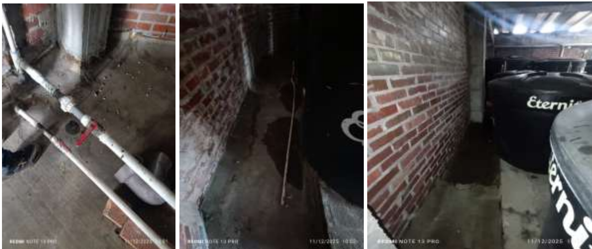
Condiciones actuales de la red y tanques de abastecimiento.
