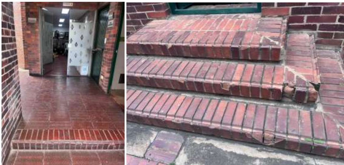
El piso en tablón presenta una superficie opaca y manchada, lo cual requiere labores de limpieza y mantenimiento. Adicionalmente, se evidencia piezas rotas.
