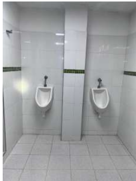
Baño - Ausencia de división de orinal y grifería tipo push derecha sin funcionamiento.
