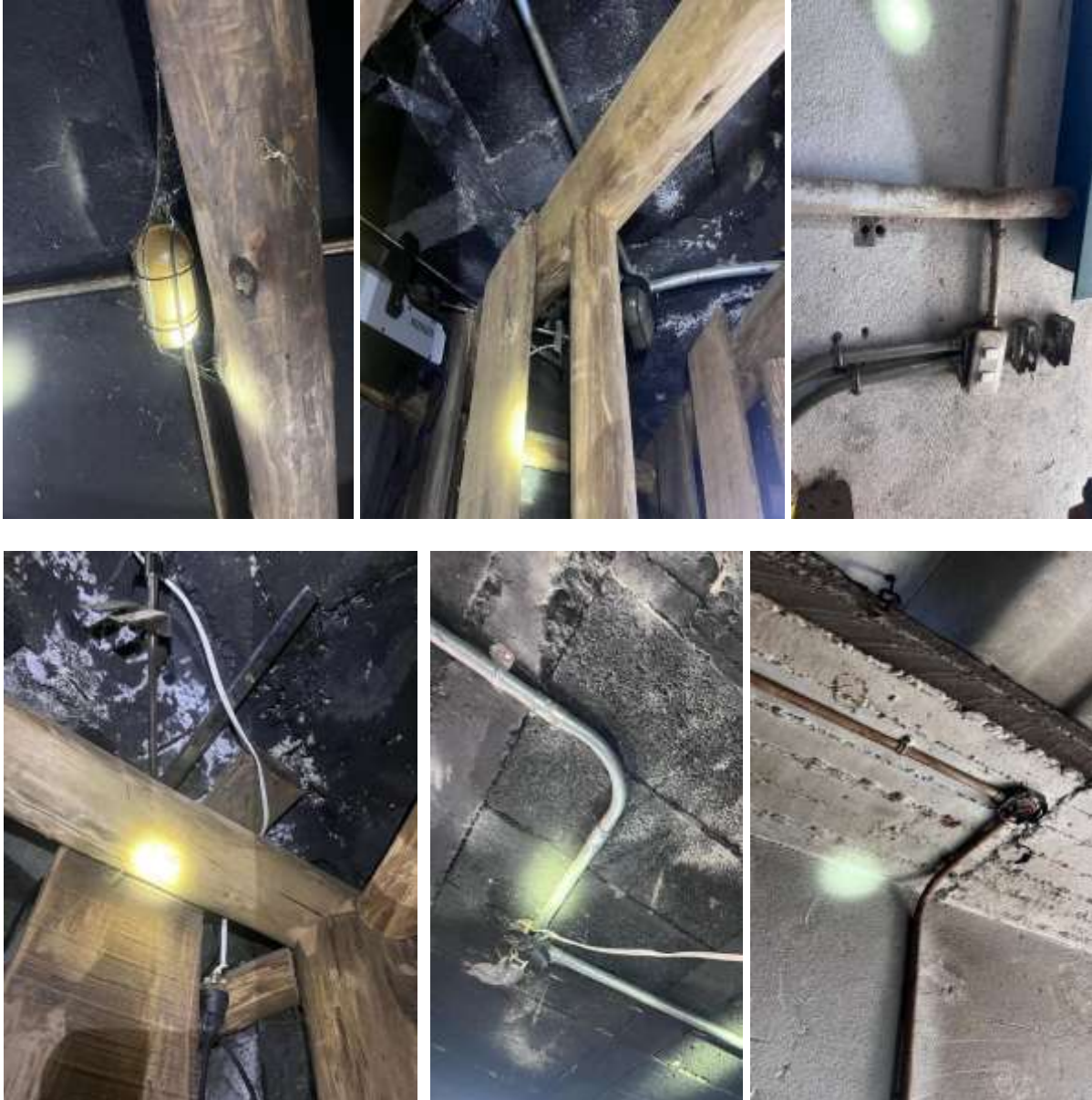
Red eléctrica interior – torre de entrenamiento.
