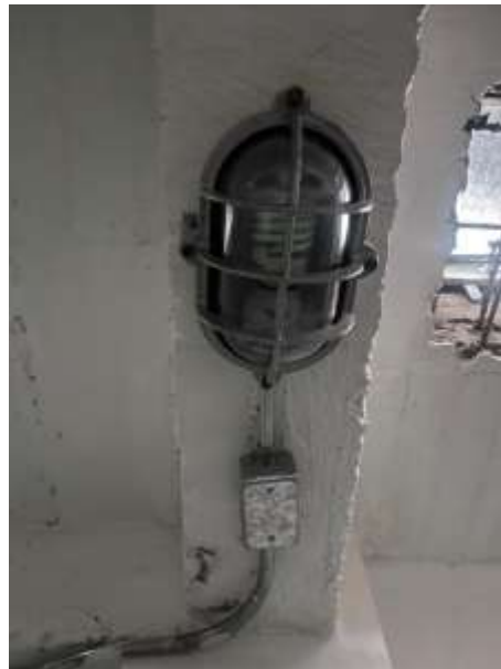
Luminaria interior sin funcionamiento
