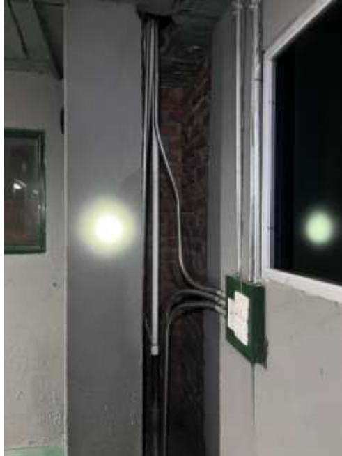
Ducto que requiere cerramiento
