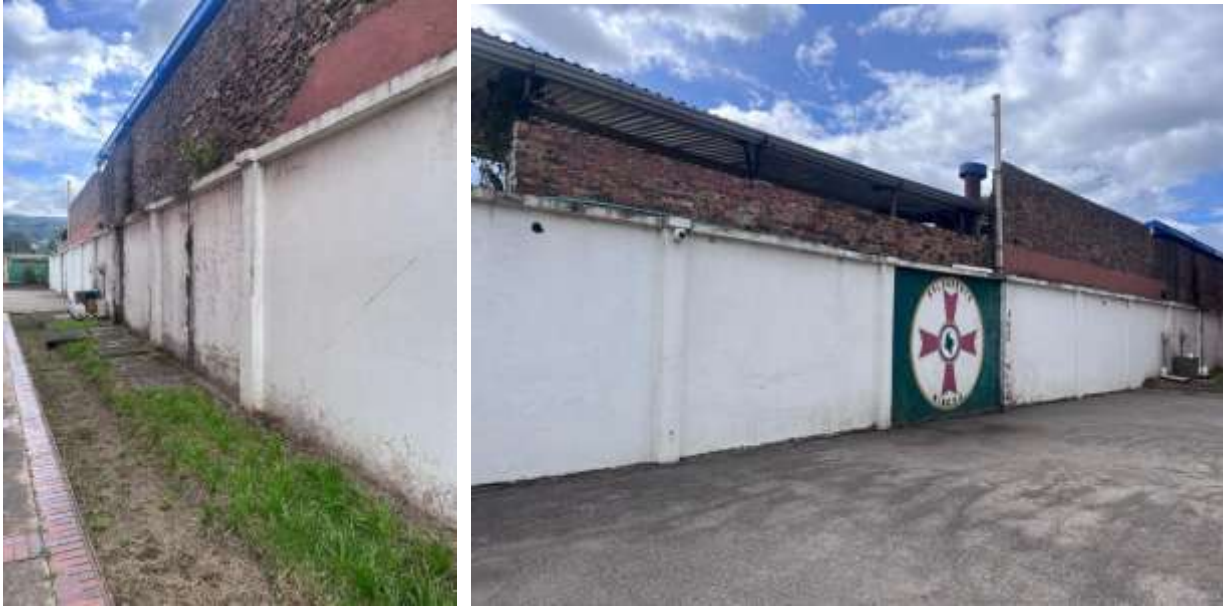
Estado actual del muro de cerramiento de la sede; se evidencia deterioro asociado a la presencia de humedad.
