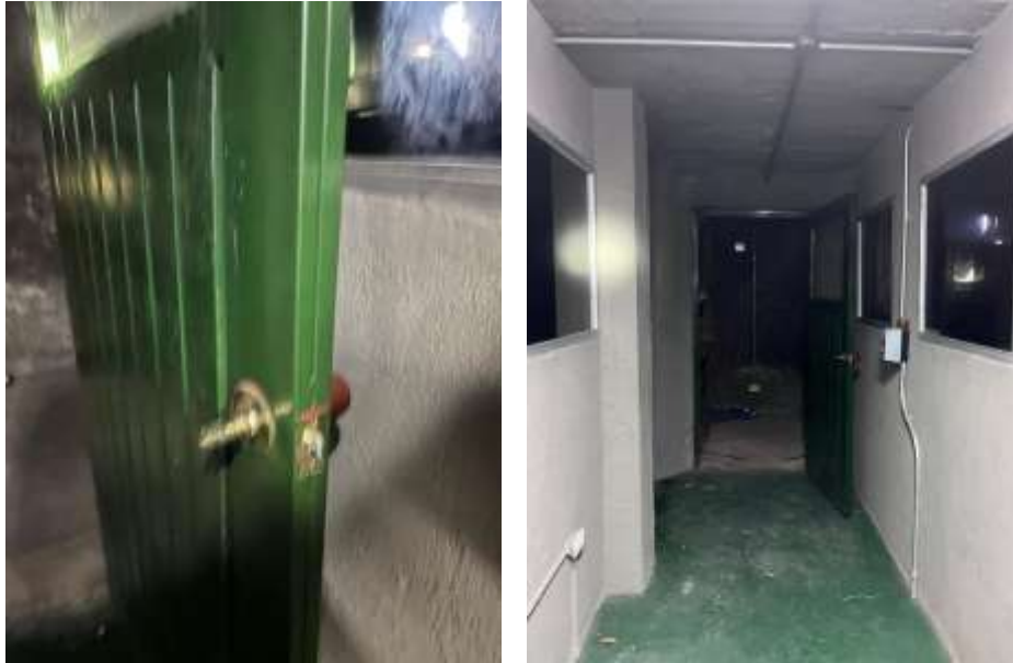
Condiciones de las puertas y chapas en general.
