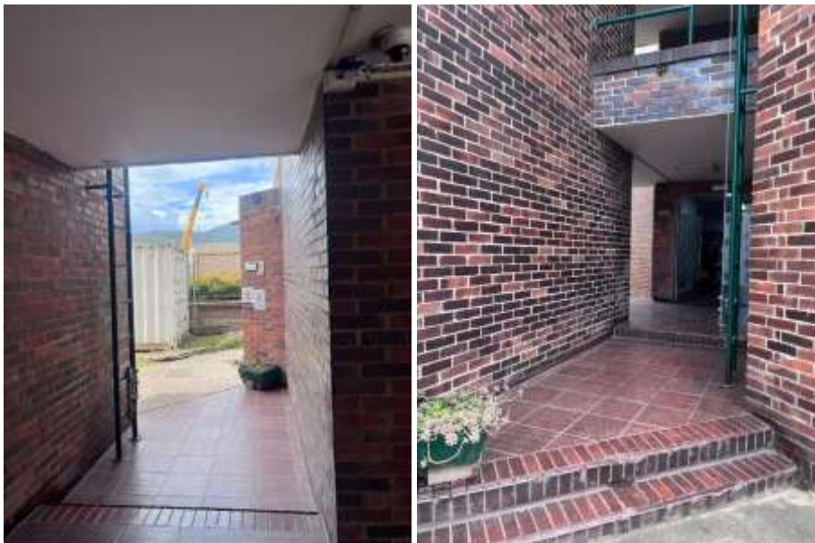
La escalera de gato ubicada en la fachada posterior requiere la instalación de anclajes certificados para la línea de vida, a fin de cumplir con las condiciones de seguridad exigidas.
