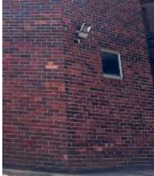
El reflector instalado sobre el muro de la fachada presenta daño y no se encuentra en funcionamiento
