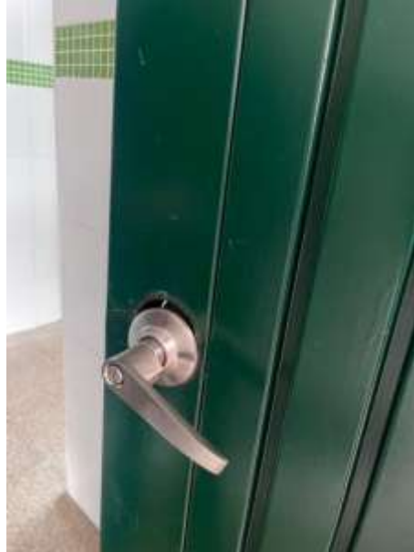
Estado actual de la manija de la puerta del baño
