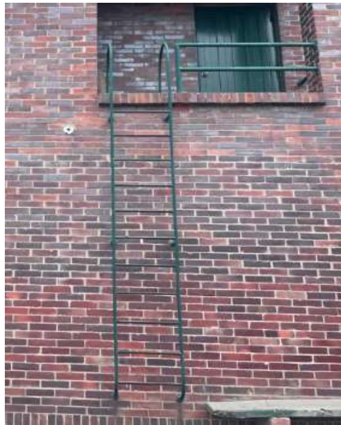
La escalera de gato ubicada en la fachada de acceso a la torre requiere mantenimiento general, especialmente la aplicación de pintura.
