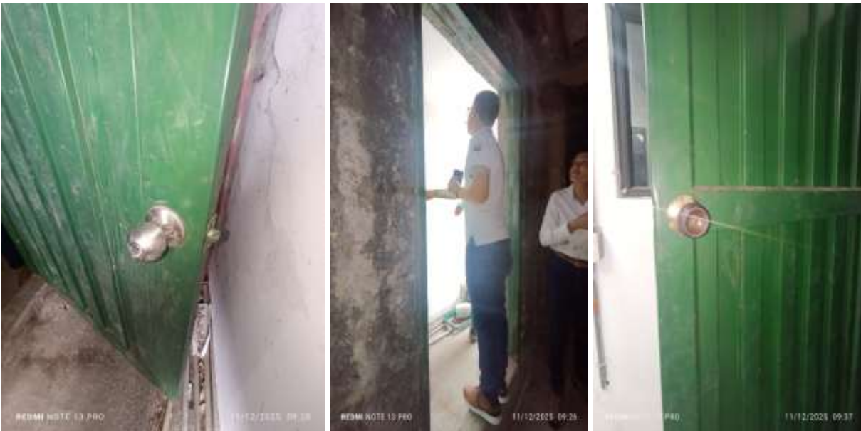
Condiciones actuales de las puertas.
