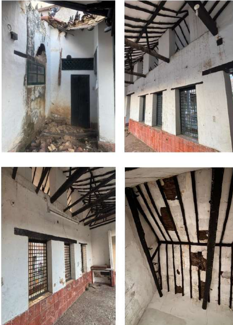
Ilustración 1 Estado de conservación del inmueble.
