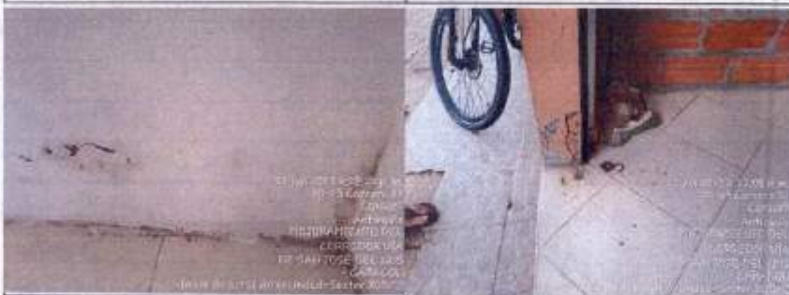
Descripción: HUMEDAD EN PARED Descripción: DESPRENIMIENTO DE MATERIAL
