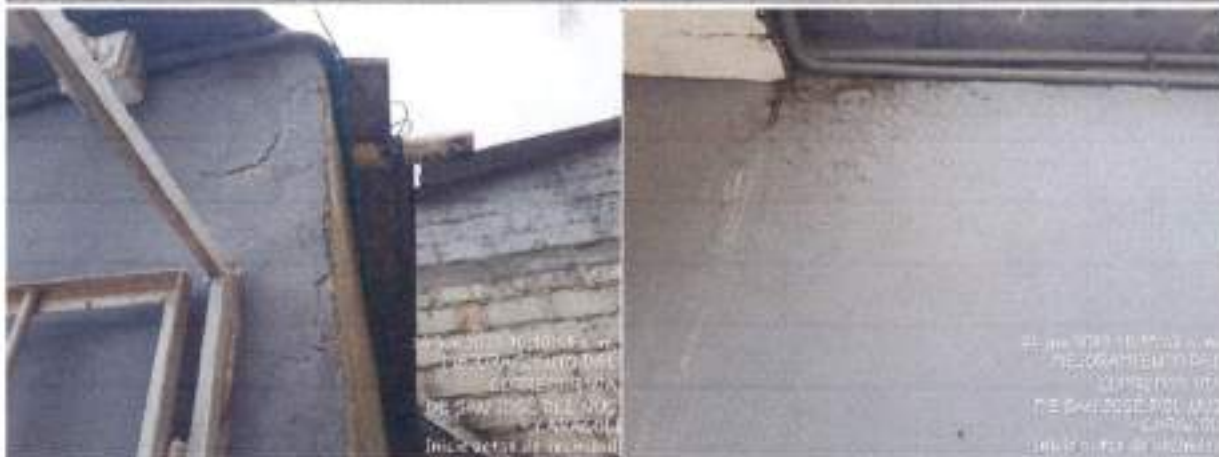
Descripción: DESPRENDIMIENTO MATERIAL
