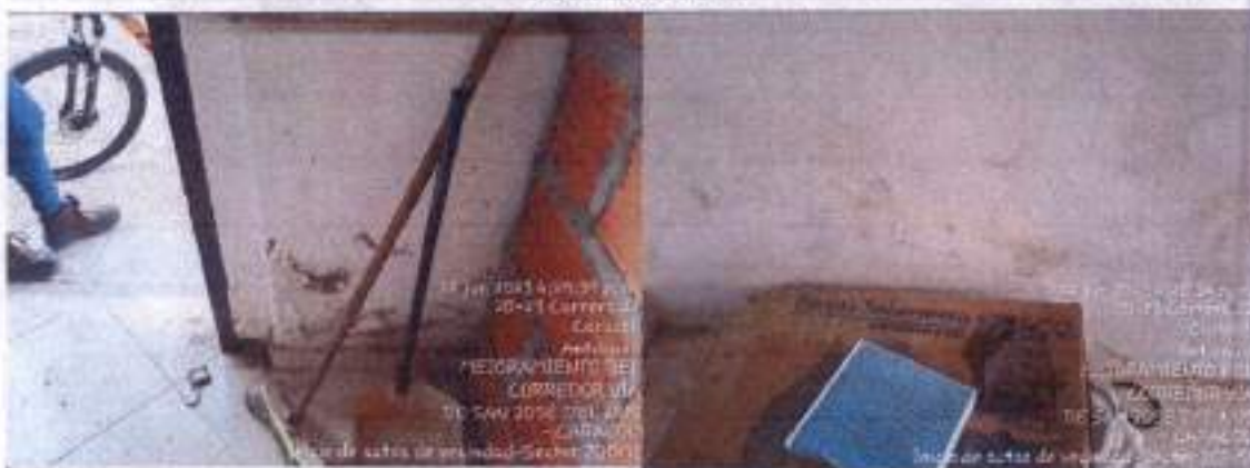
Descripción: HUMEDAD PARED Descripción: HUMEDAD PARED
