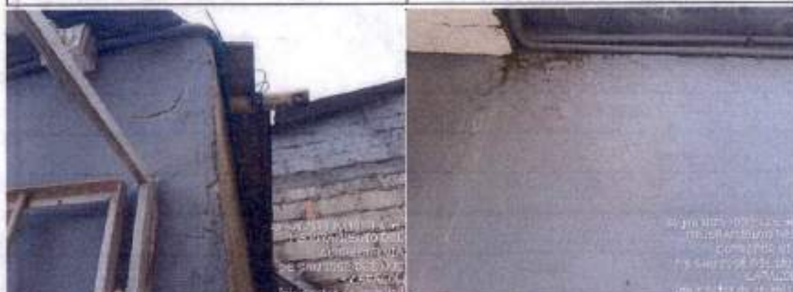
Descripción: DESPRENDIMIENTO MATERIAL
