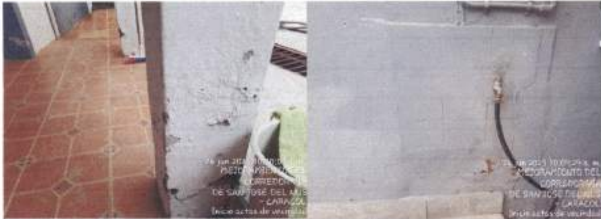
Descripción: HUMEDAD EN COLUMNA
