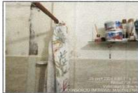
Observaciones: Baño humedad
