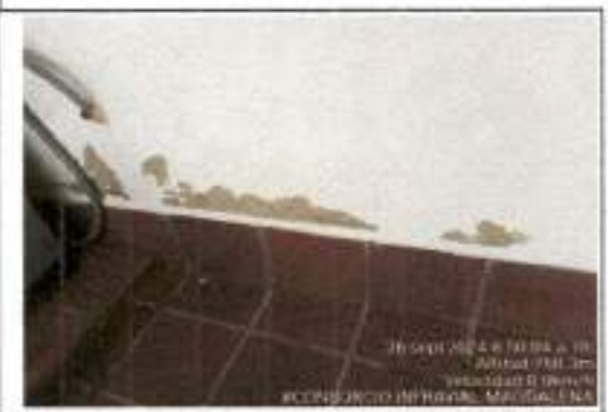
Observaciones: Humedad zona humedad
