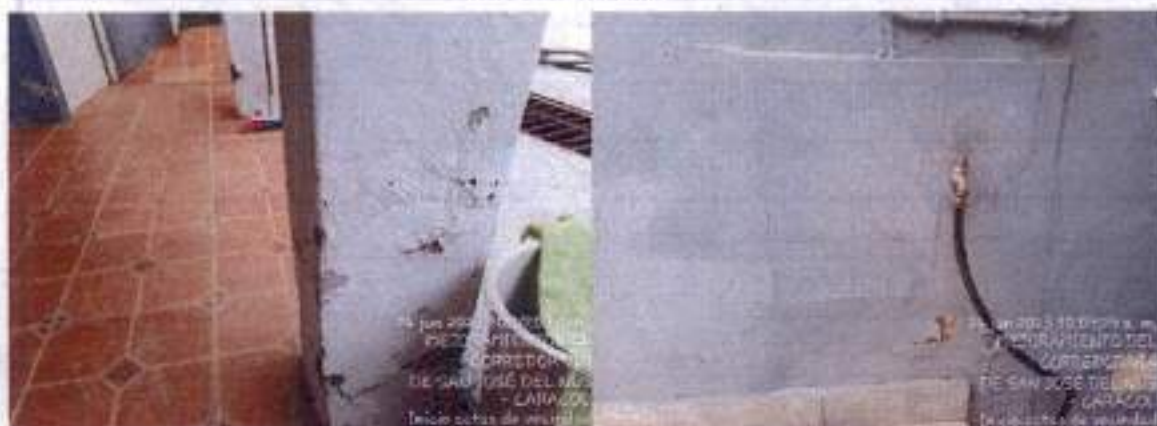
Descripción: HUMEDAD EN COLUMNA
