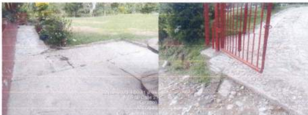
Descripción: GRIETA PISO
