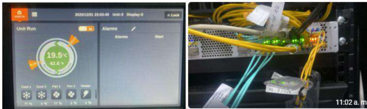
Ilustración 3 Registro fotográfico Visita diagnóstico Datacenter
