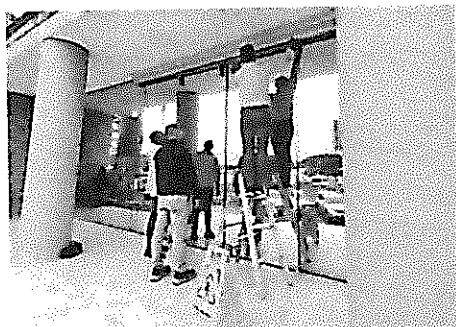
Imagen 4. Evidencia desmonte tapa protectora mecanismos
