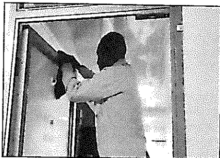
Imagen 28. Evidencia Mantenimiento imán DESET
