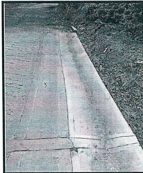
Ilustración 4. Drenaje constante por conexiones de acueducto veredal
