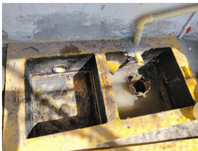
Trampa de grasas No 3 Cafetería complejo industrial
