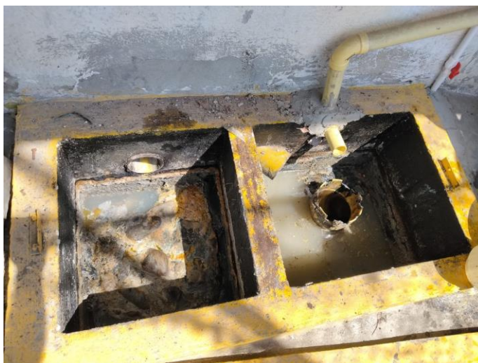
Trampa de grasas No 3 Cafetería complejo industrial
