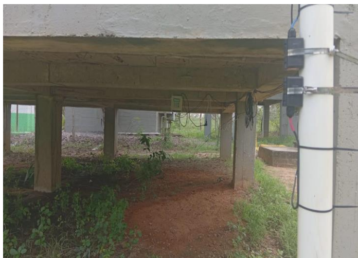
Foto 3. Vista general del sistema instalado. Unidad transmisora (al fondo, bajo losa) y tubería de 3" con transductores fijados mediante abrazaderas de acero inoxidable. (CABP, Marzo 2026)
