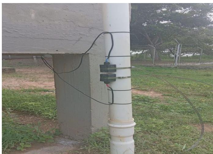
Foto 4. Detalle de los transductores ultrasónicos clamp-on instalados en la tubería PVC DN 80 mediante abrazaderas de acero inoxidable. Cableado protegido y asegurado a la tubería. (CABP, Marzo 2026)
