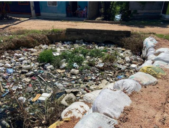
Evidencia fotográfica 41. Tramo caño Belén estado inicial barrio San José
