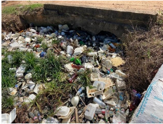
Evidencia fotográfica 39. Tramo caño Belén estado inicial barrio San José
