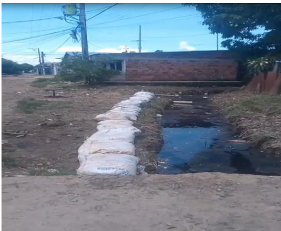
Evidencia fotográfica 35. Tramo caño Belén muro de protección con relleno barrio Belén
