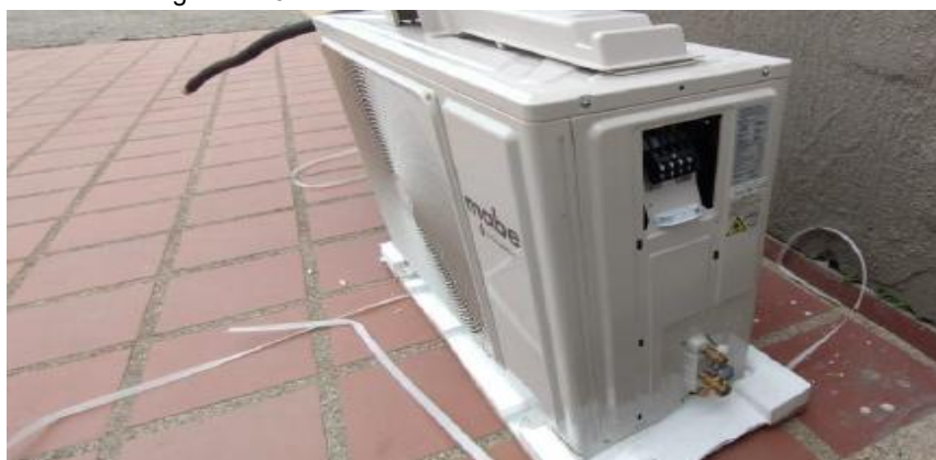
Imagen No. 4: ITEM 11 condensadora aire acondicionado marca MABE
