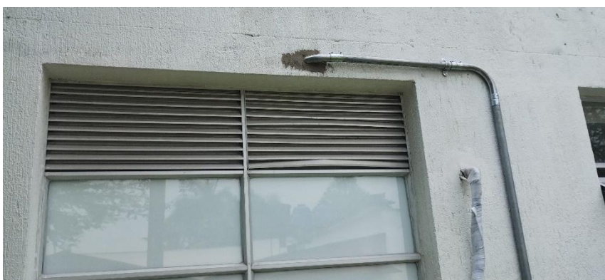
Imagen No. 24: ítem 32 Distribución eléctrica del centro de control
