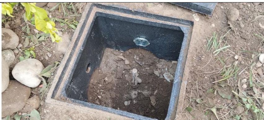
Imagen No. 25: ítem 32 Distribución eléctrica del centro de control, caja de inspección
