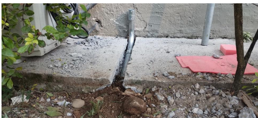
Imagen No. 26: ítem 32 Distribución eléctrica del centro de control, ductería
