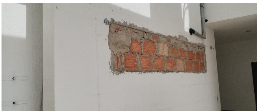
Imagen No. 18: ítem 30 adaptación centro de monitoreo y cuarto de equipos
