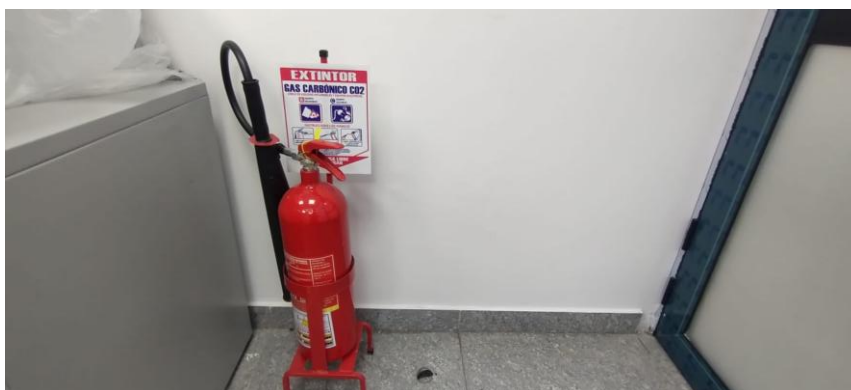
Imagen No. 17: ítem 27 Sistema de detección de incendios, extintor
