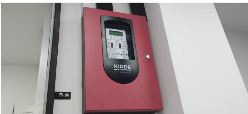
Imagen No. 14: Ítem 27: Sistema de detección de incendios
