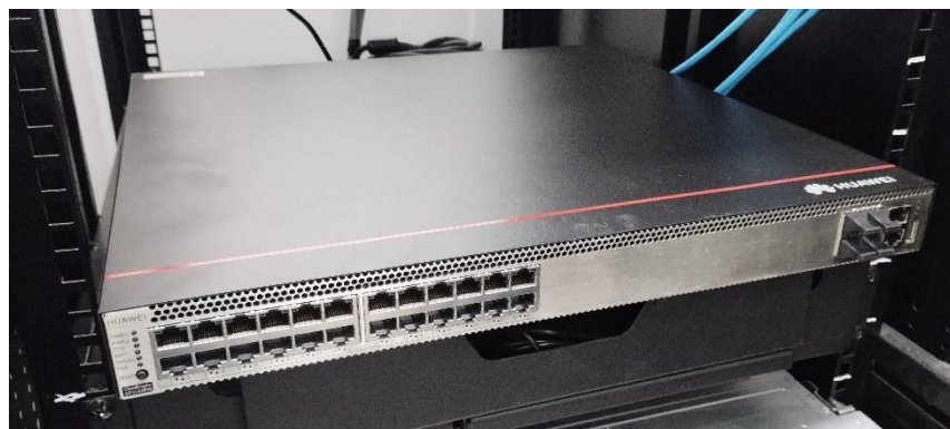
Imagen No. 7: ítem 35, switch tipo 4 marca HUAWEI
