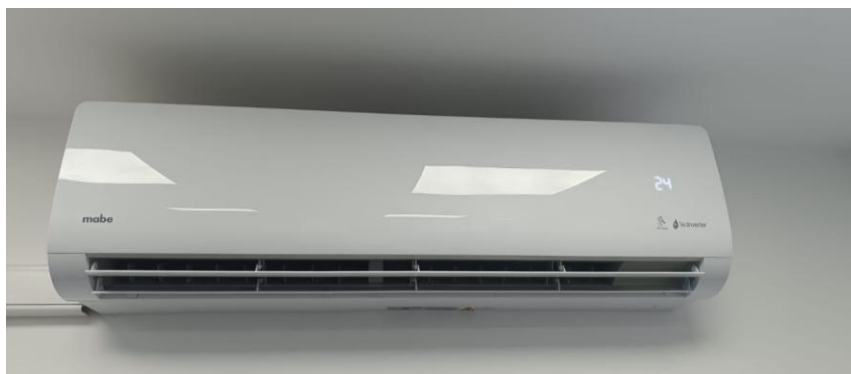
Imagen No. 3: ITEM 11 Aire acondicionado marca MABE
