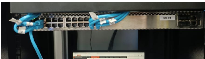
Imagen No. 6: ítem 35, switch tipo 4 marca HUAWEI
