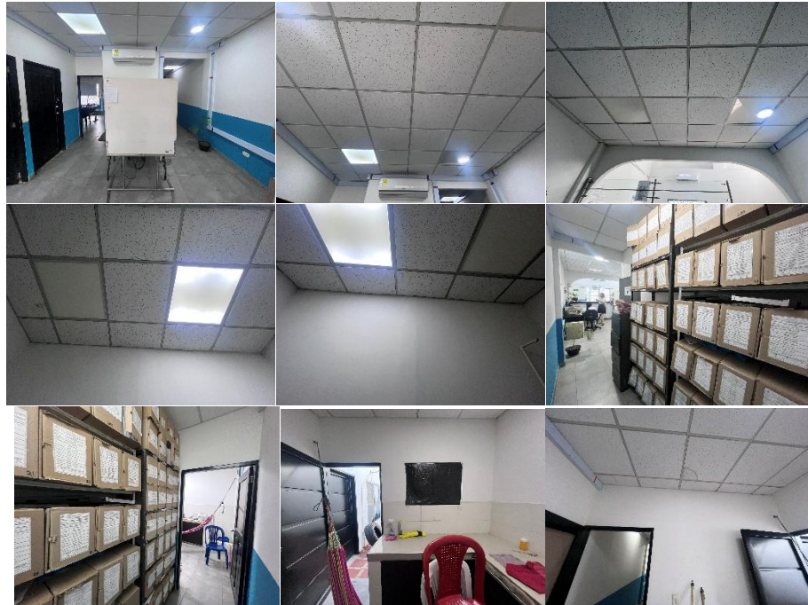
Imagen 3. Estado actual inmueble Registraduría Municipal de Planeta Rica (Córdoba).
