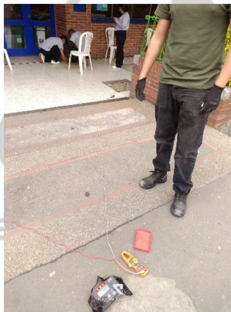
FIGURA 9 MEDICION DE CONTINUIDAD POLO A TIERRA A PUNTA FRANKLIN COLEGIO SAN AGUSTIN IED
