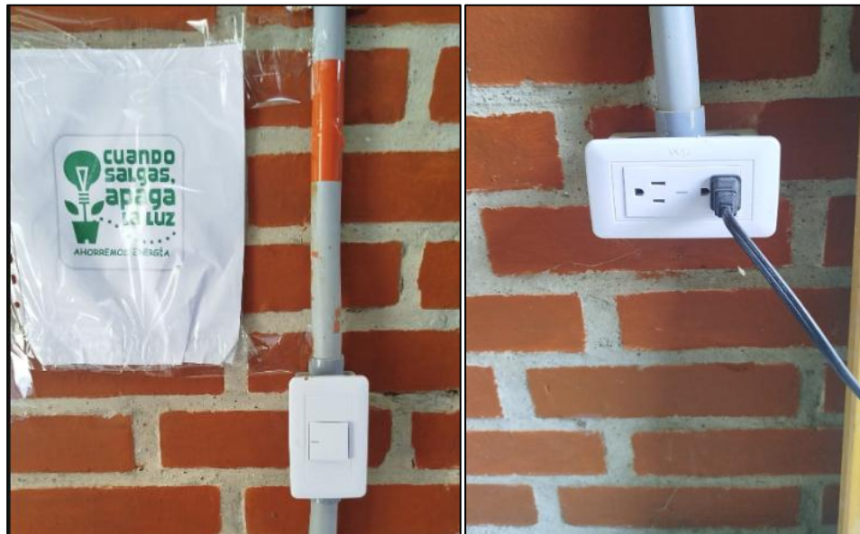
Imagen 54. Señalización, tomacorrientes y enchufes.
