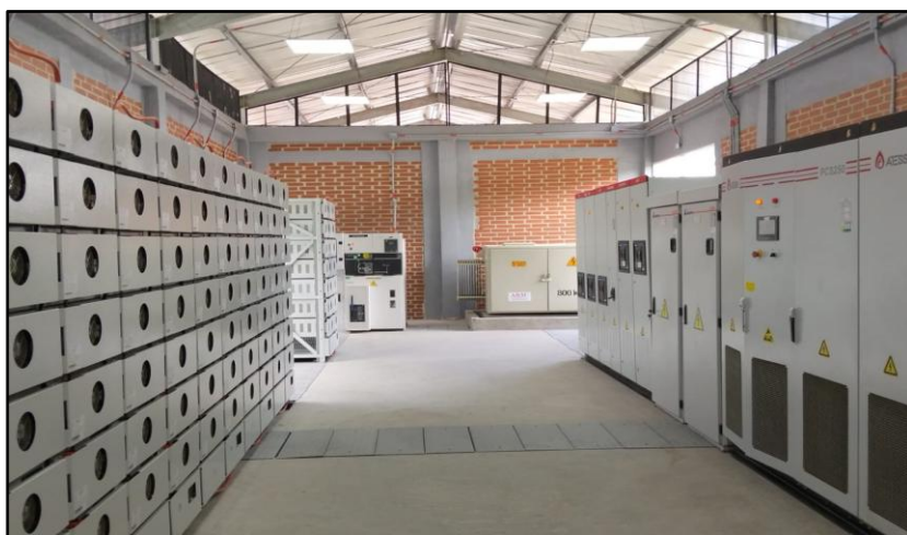
Imagen 52. Registro fotográfico central de generación en correcto orden.
