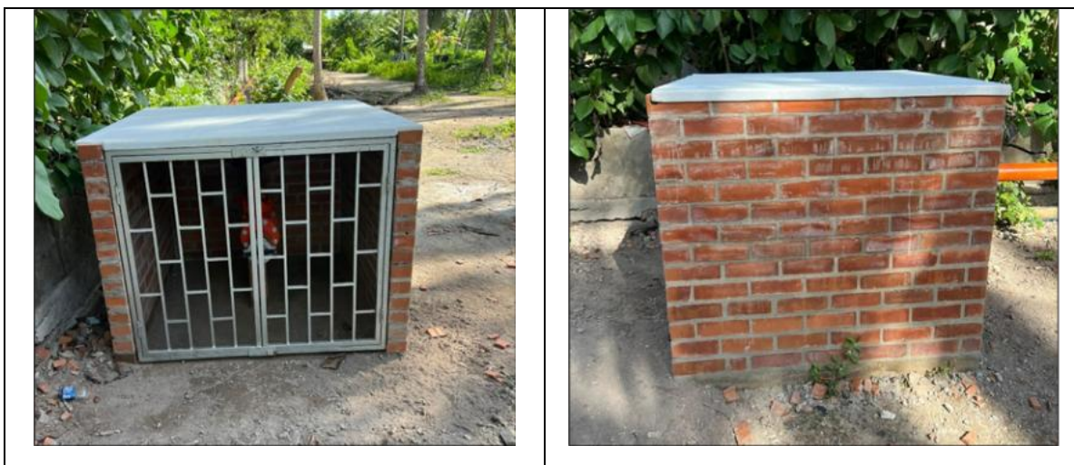
Imagen 38. Caseta de poliducto.
