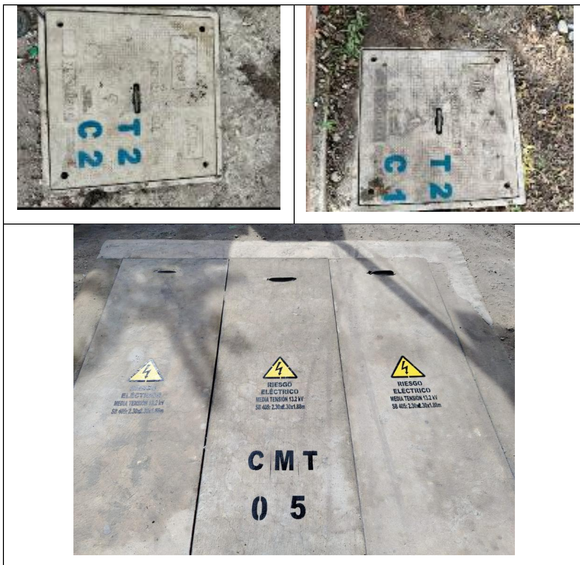
Imagen 44. Cajas BT y MT señalizadas.
