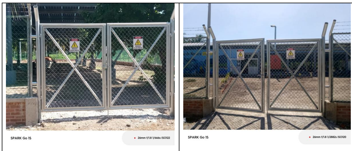
Imagen 45. Cerramiento señalado con riesgo eléctrico.
