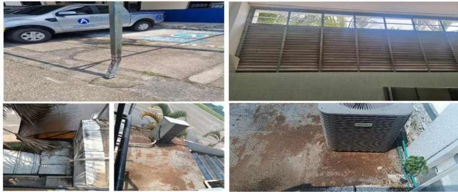
Ilustración 6 Estado de estructura metálica presencia de óxido de corrosión Fuente: propia
