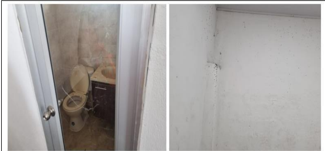
Ilustración 10 Estado de los muros internos y baños de bodegas, áreas con alta presencia de polvo, telarañas y humedad Fuente; propia
