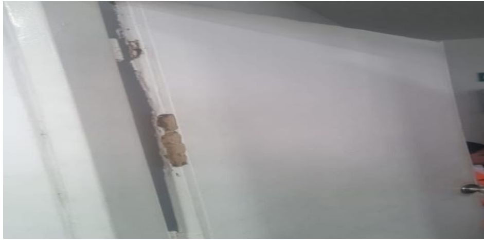
Ilustración 8 Estado de puerta de madera evidencia de daño por termitas, Fuente: propia
