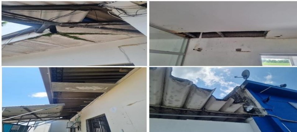
Ilustración 7 Estado de la cubierta y el cielo raso, evidencia de año, suciedad y piezas faltantes fuente propia
