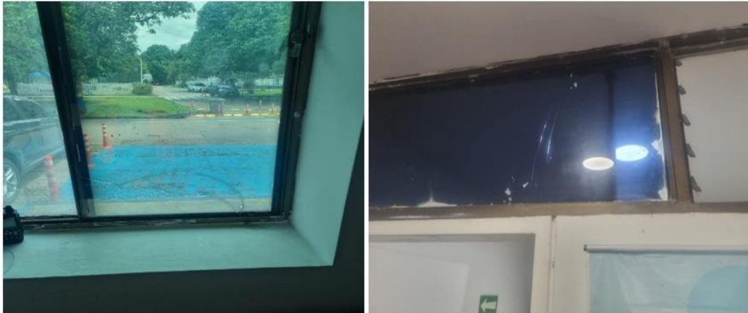
Ilustración 9 Estado de los cristales de las ventanas, se presentan fisuras y vidrios faltantes Fuente: propia
