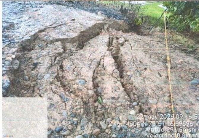
Anexo 2. Fisuras internas del predio colindante con la vía k 6 + 155.
