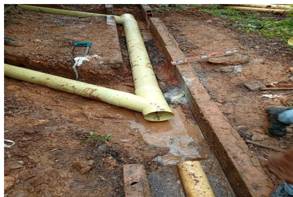
Foto 8. Ensamble de accesorios y ramal de descarga hacia el biodigestor
