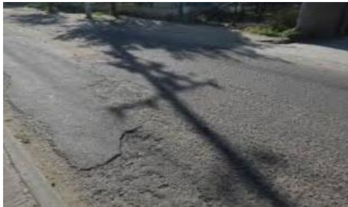
Fig. 4 Perdida de agregado (Pavimento Flexible)
