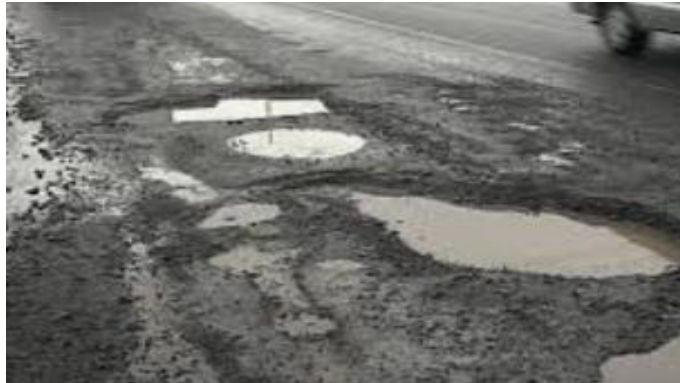
Fig. 3 Baches (Pavimento Flexible)
