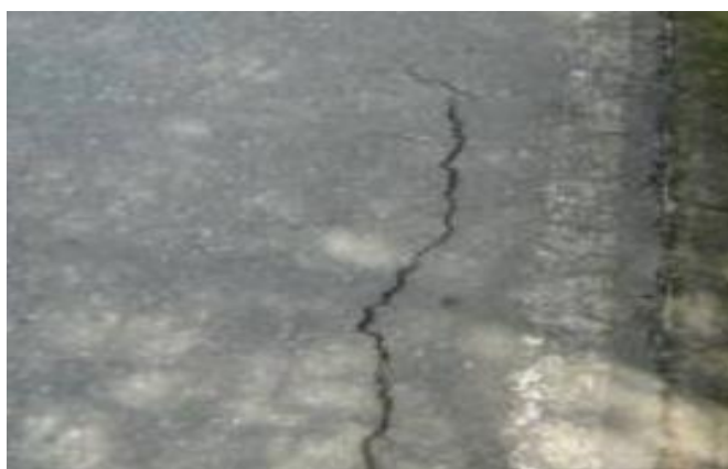
Fig. 1 Fisuras en media luna (Pavimento Flexible)
