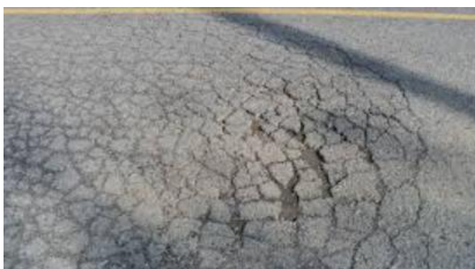
Fig. 2 Piel de Cocodrilo (Pavimento Flexible)
