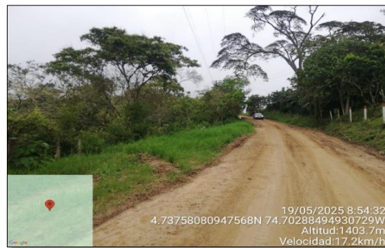
Fuente: Interventoría Consorcio ID Cundinamarca 043 Foto 11. K4+100 estado inicial punto crítico Ambos carriles
