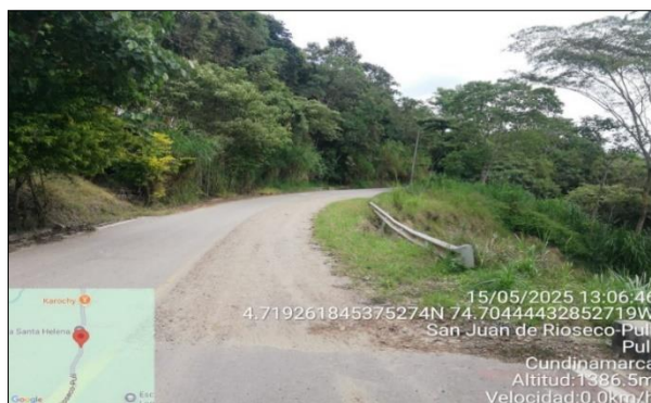
Fuente: Interventoría Consorcio ID Cundinamarca 043 Foto 7. K2+840 estado inicial punto crítico No 6 Costado Izquierdo
