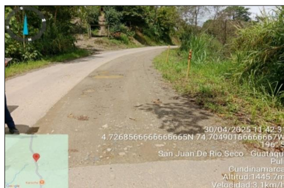
Fuente: Interventoría Consorcio ID Cundinamarca 043 Foto 8. K3+750 estado inicial punto crítico No 7 Costado Izquierdo
