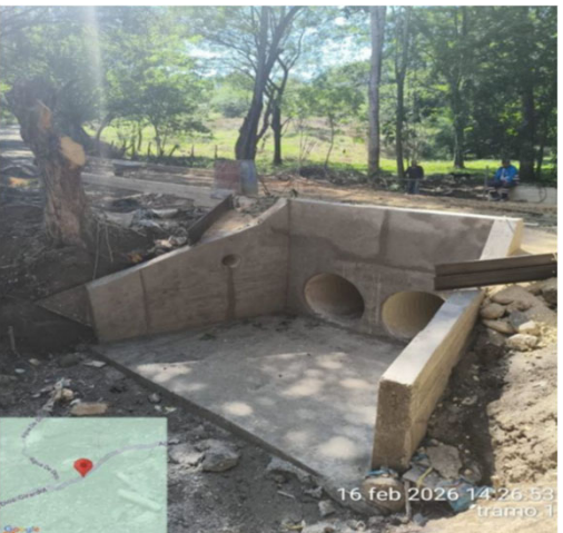
Fotografía 5: Descole alcantarilla doble
