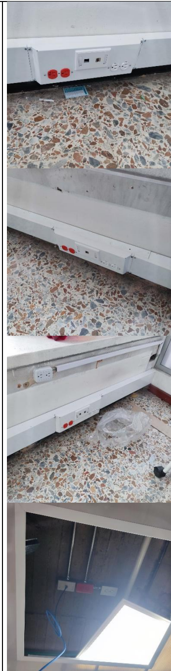
Evidencia fotográfica de los puntos instalados en el área de bienestar y comedor
