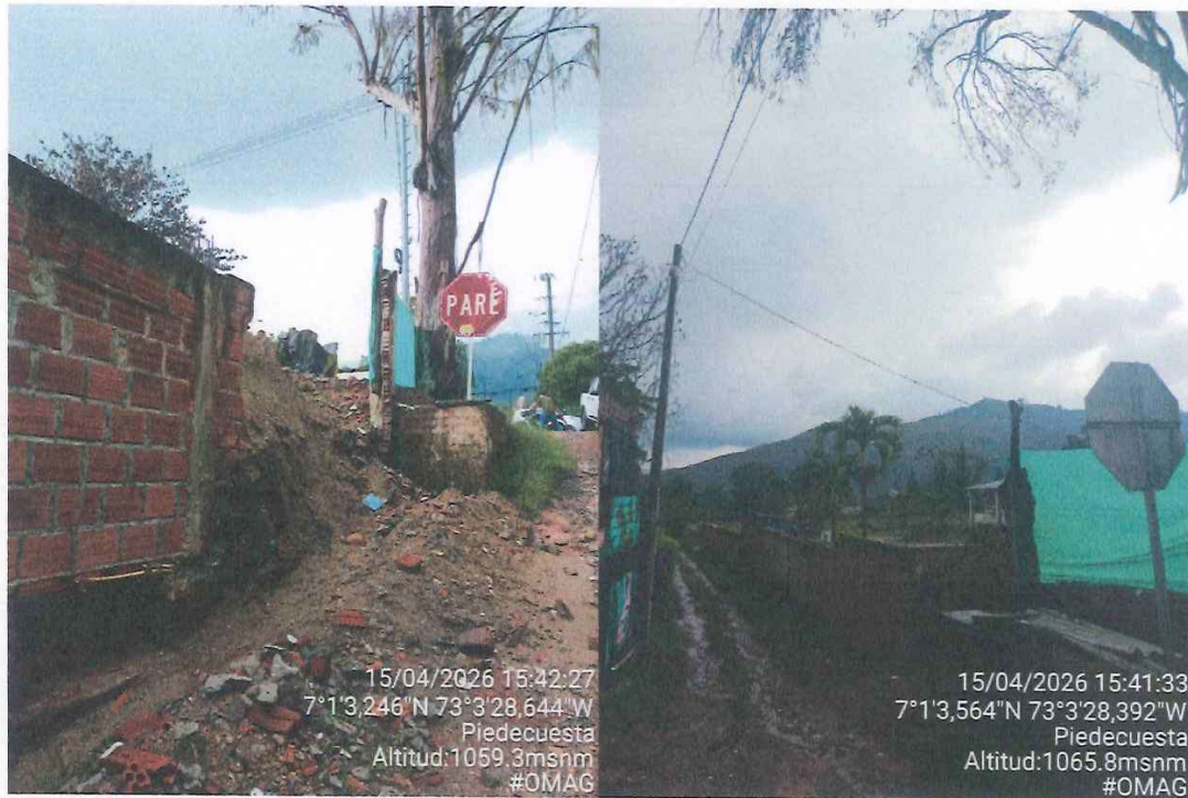
Registro fotográfico 4. Cerramiento perimetral, lateral del predio, árbol de Eucalipto seco.
