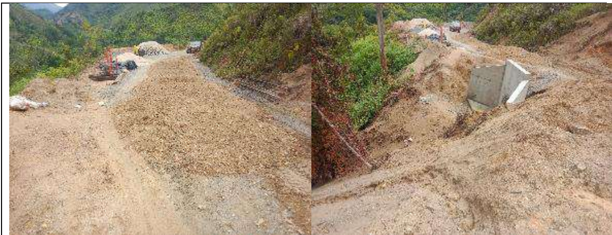
Vía completamente cerrada y sin señalización
