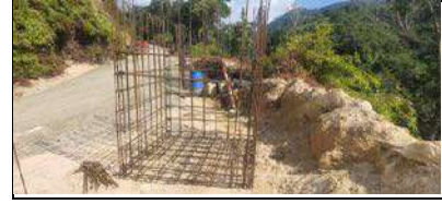
acero caja alcantarillas tramo 1 Baticola
