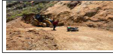
DESIZAMINETO DE TIERRA FALTA DE SEÑALIZACION
