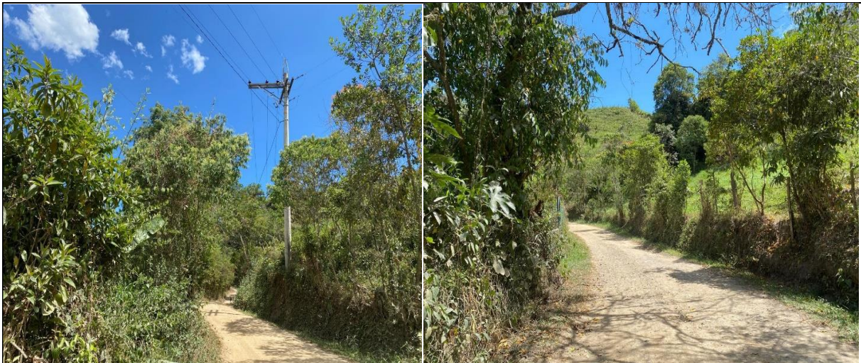
En la anterior imagen se observa el estado actual de la Vía que comunica la vereda Centro con la vereda la Alianza sector la Concepcion del municipio de la Vega
