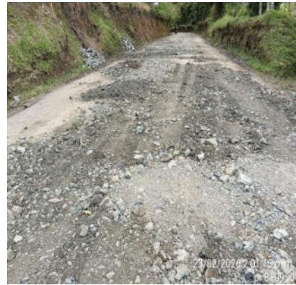
Fotografía 3. Sitio crítico después PR 8+0950
