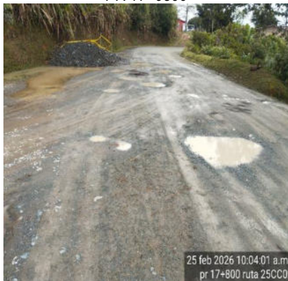
Fotografía 11. Sitio crítico antes PR 17+0800
