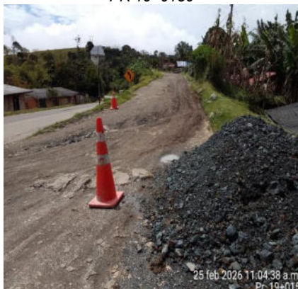
Fotografía 13. Sitio crítico antes PR 19+0150
