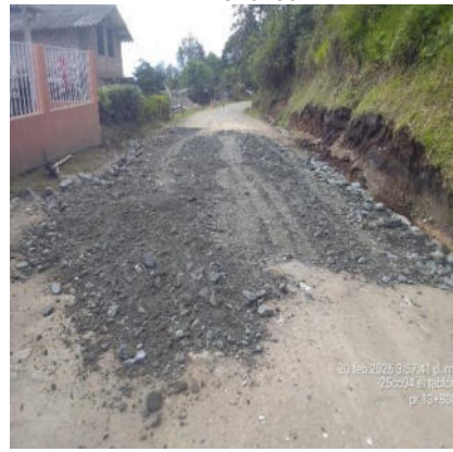
Fotografía 3. Sitio crítico después PR 13+0700
