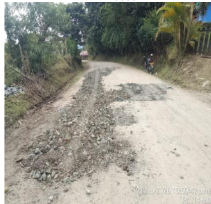
Fotografía 3. Sitio crítico después PR 14+0800
