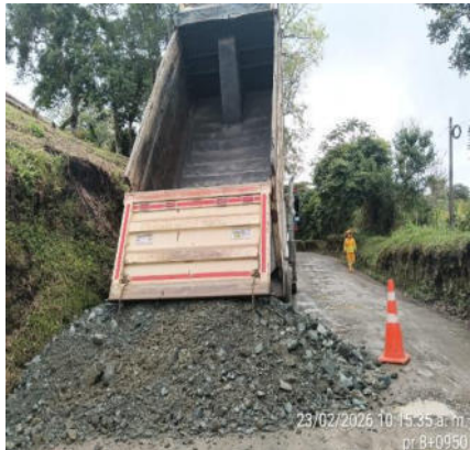
Fotografía 1. Sitio crítico antes PR 8+0950
