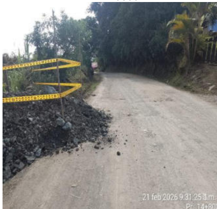
Fotografía 5. Sitio crítico antes PR 14+0800
