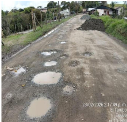
Fotografía 3. Sitio crítico antes PR 10+0500
