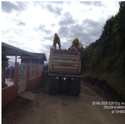
Fotografía 7. Sitio crítico antes PR 13+0700
