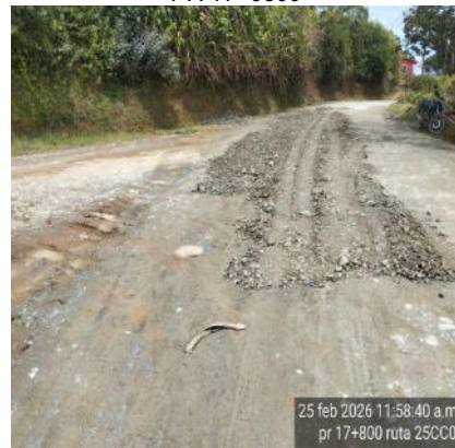
Fotografía 3. Sitio crítico después PR 17+0800
