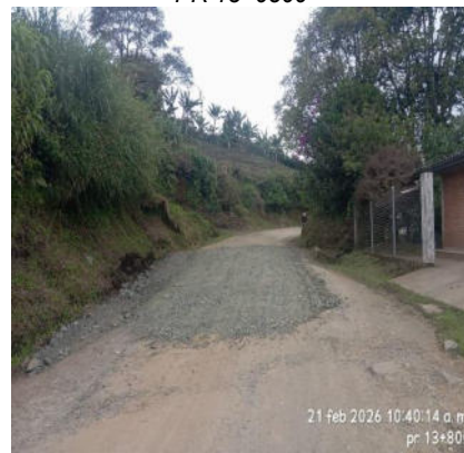
Fotografía 3. Sitio crítico después PR 13+0800
