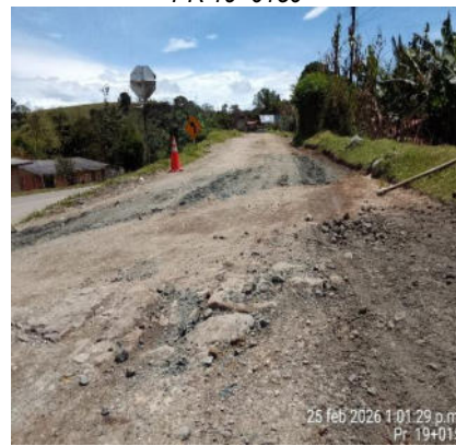
Fotografía 3. Sitio crítico después PR 19+0150
