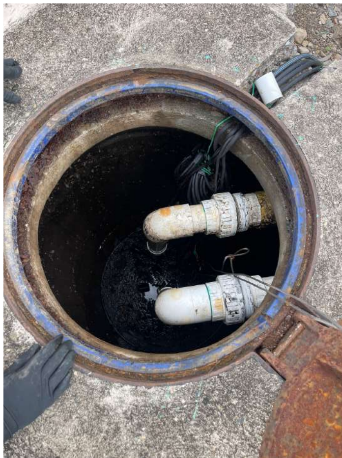
Imagen 11 a 13. Retiro de sistema de bombeo. Exceso de basura en pozo de bombeo
