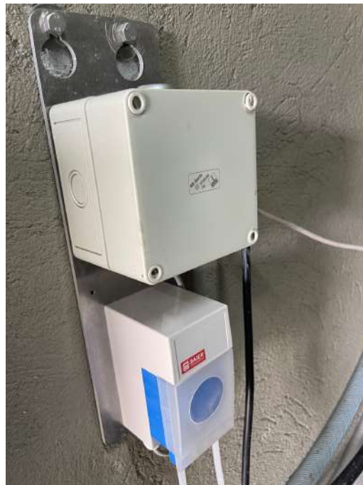
Imagen 27. Mantenimiento de compresor, bomba peristáltica, electrodos y equipos.
