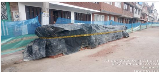
Señalización de material CIV 8010914-8010695 (N26-N27)
