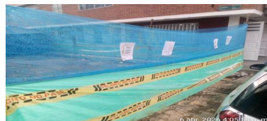
Actualización de señalización SST en los siguientes CIV S: 8009556-8009549,8010914-8010695, 8009456 , 8009473 , 8007698 , 8010826.
