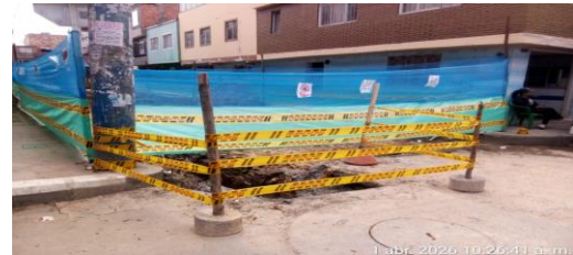
Señalización perimetral CIV 8009473 (N12)
