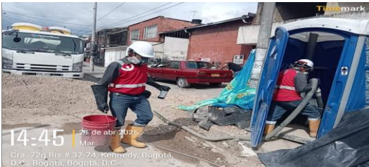
Mantenimiento de unidad sanitaria CIV 8007698 (N24)
