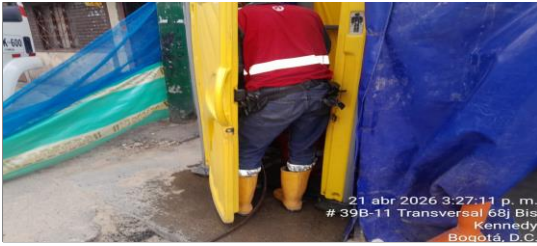
Mantenimiento de unidad sanitaria CIV 8010826 (N29)
