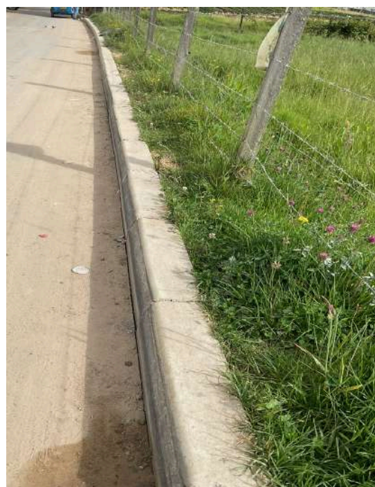
K+390 A K+350 COSTADO NORTE DESPLAZAMIENTO DE SARDINELES, DESALINEO, DESPORTILLADOS, EN MAL ESTADO.
