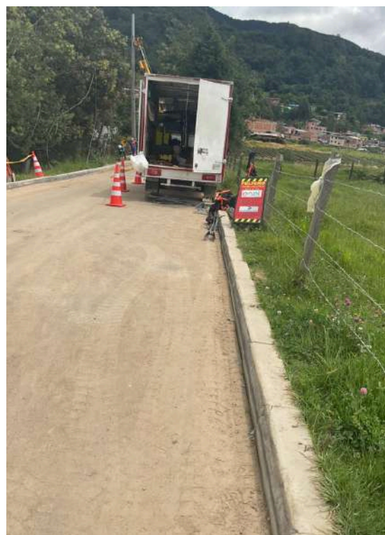
K+390 COSTADO NORTE, DESALINEO SARDINELES, DESPORTILLADOS, MANCHADOS, FISURADOS
