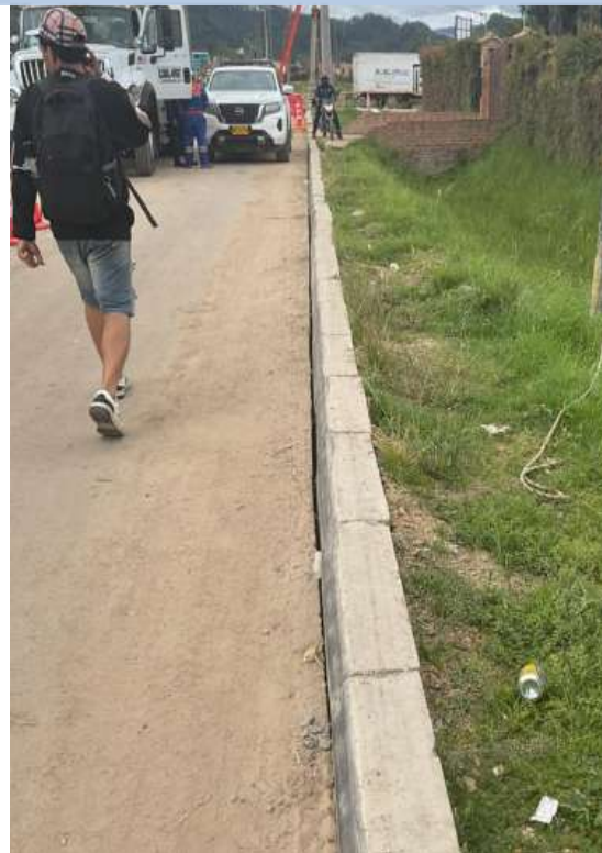
K+410 K+ 390 COSTADO SUR DESALINEO SARDINELES, DESPORTILLADOS, MANCHADOS, FISURADOS
