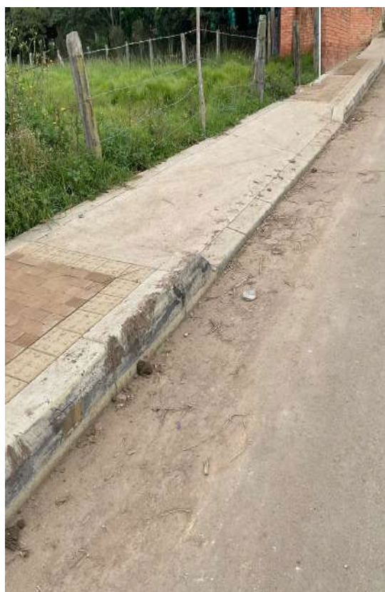
SARDINELES, DESPORTILLADOS, MANCHADOS, FISURADOS
