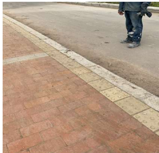
K+480 HUNDIMIENTO DE ANDENEN, LOSETA PREFABRICADA, ADOQUIN.
