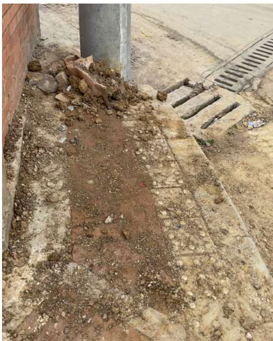
INSTALACIÓN DE POSTES DESPRENDEN ADOQUIN, SIN ASEO, SIN CONFINAR
