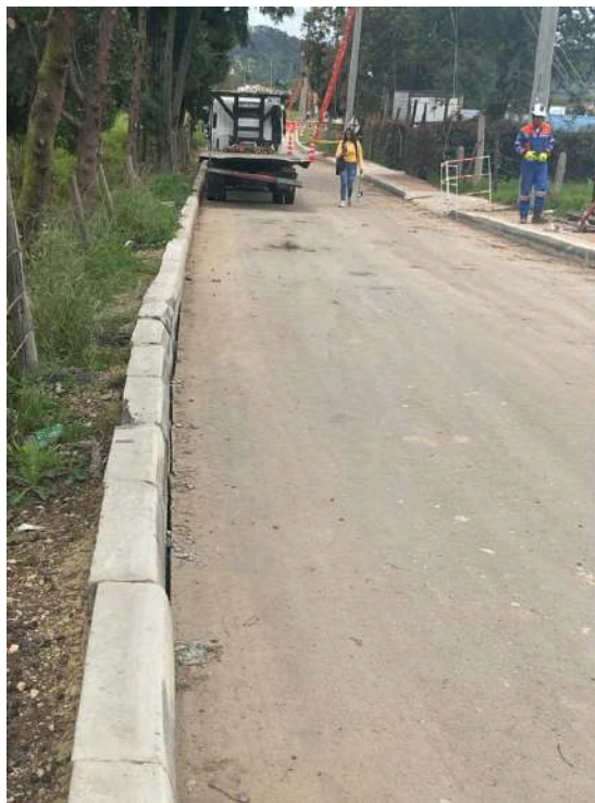
K+470 K+450 NORTE DESALINEO SARDINELES, DESPORTILLADOS, MANCHADOS, FISURADOS
