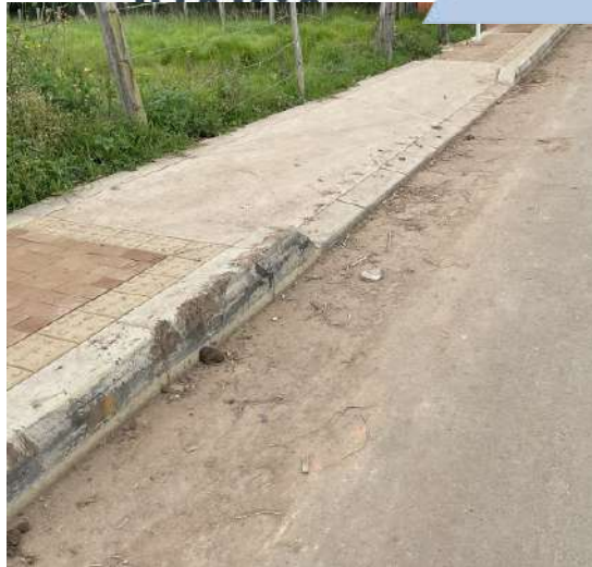
K+500500 DESASEADO, MANCHAS FISURAS.
