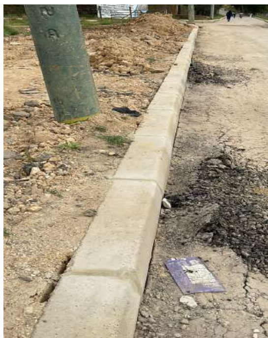
K+ 320 DESPRENDIMIENTO DE SARDINELES, DESPORTILLADOS, MANCHADOS, FISURADOS
