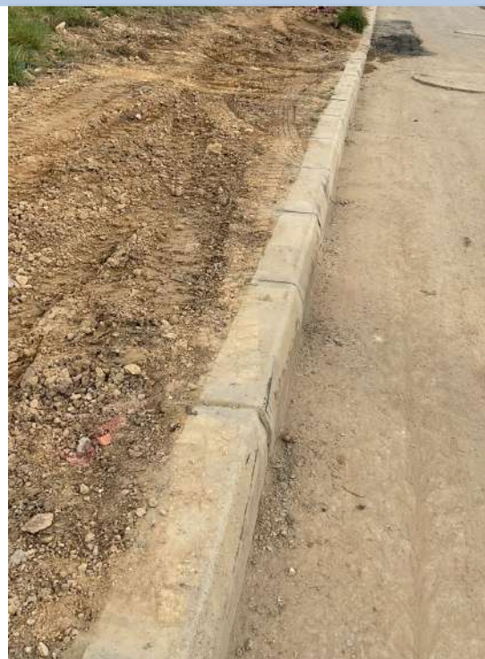
K+240 DESPRENDIMIENTO DE SARDINELES, DESPORTILLADOS, MANCHADOS, FISURADOS
