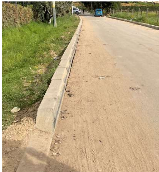
K+350 A K+390 DESALINEO SARDINELES, DESPORTILLADOS, MANCHADOS, FISURADOS
