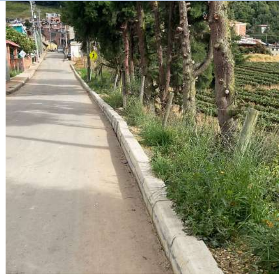
K+ 480 DESPRENDIMIENTO DE SARDINELES, DESPORTILLADOS, MANCHADOS, FISURADOS.
