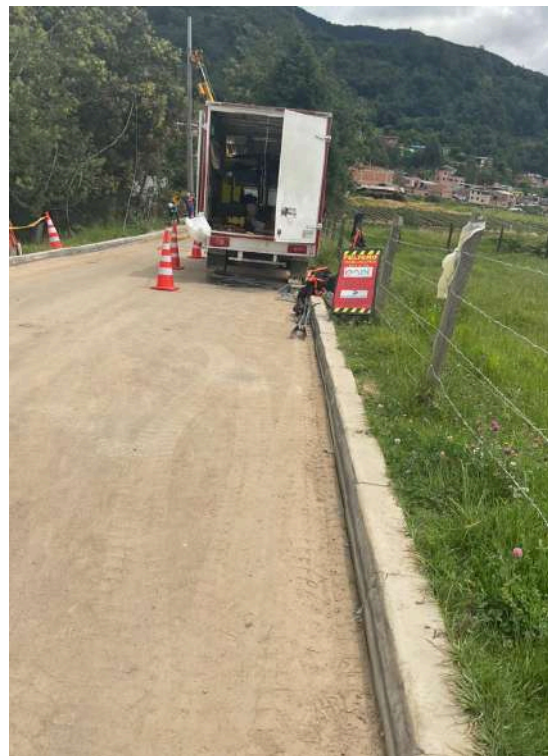
K+390 COSTADO NORTE, DESALINEO SARDINELES, DESPORTILLADOS, MANCHADOS, FISURADOS
