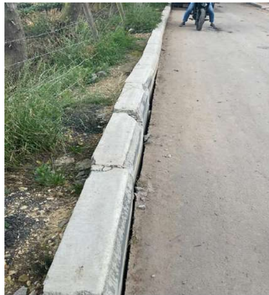
K+470 DESALINEO SARDINELES, DESPORTILLADOS, MANCHADOS, FISURADOS
