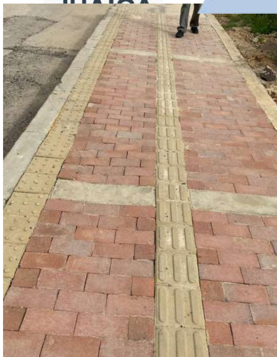
HUNDIMIENTO DE ANDÉN, LOSETA PREFABRICADA, ADOQUÍN.
