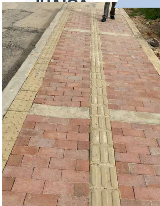
HUNDIMIENTO DE ANDÉN, LOSETA PREFABRICADA, ADOQUÍN.
