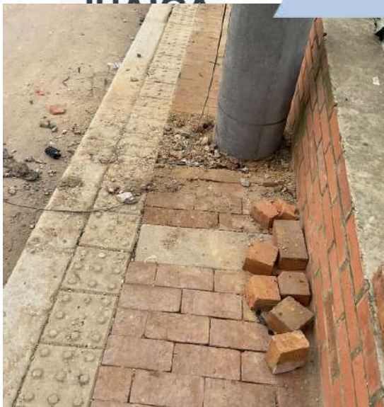
K+ 560 INSTALACIÓN DE POSTES DESPRENDEN ADOQUIN, SIN ASEO, SIN CONFINAR
