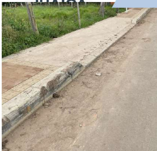
K+500 DESASEADO, MANCHAS FISURAS.
