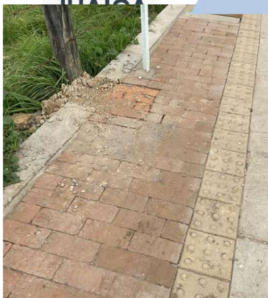
RETIRADA DE ADOQUÍN, INSTALACIÓN DE ADOQUÍN POR PARTE DE ENEL, DESNIVELADO Y SIN ASEO.
