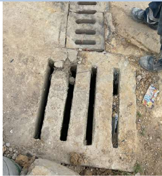
K+580 FISURA EN REJILLA DE CARCAMO
