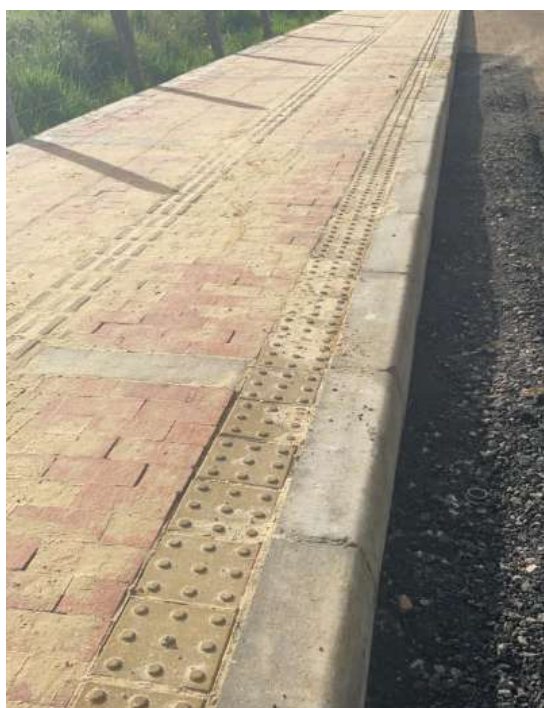
K+270 A K+240 HUNDIMIENTO DE ANDENEN, LOSETA PREFABRICADA, ADOQUIN.
