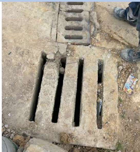
K+580 FISURA EN REJILLA DE CARCAMO
