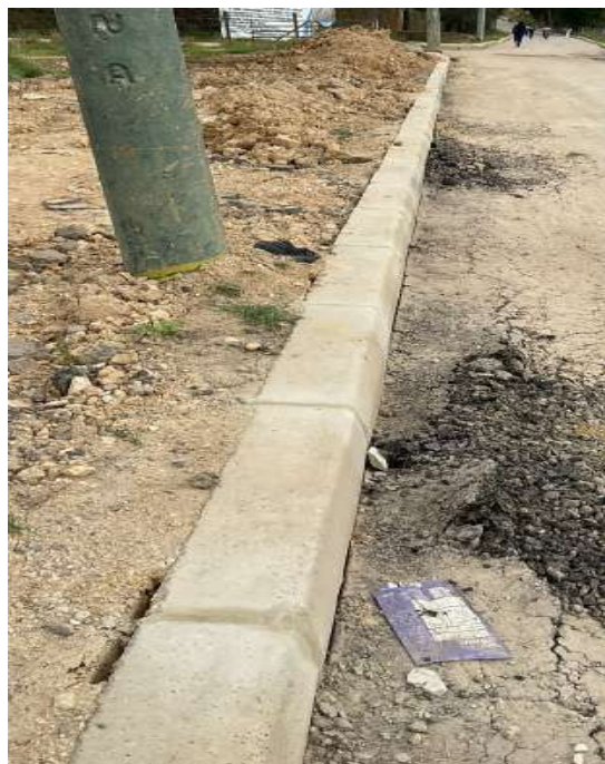
K+ 320 DESPRENDIMIENTO DE SARDINELES, DESPORTILLADOS, MANCHADOS, FISURADOS
