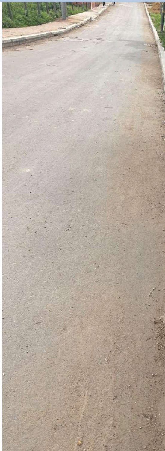
K+460 NORTE K+470 DESALINEO SARDINELES, DESPORTILLADOS, MANCHADOS, FISURADOS
