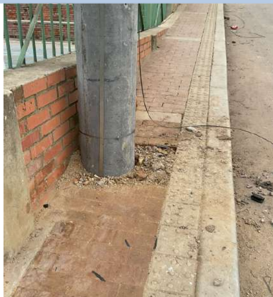
5+560 INSTALACIÓN DE POSTES DESPRENDEN ADOQUIN, SIN ASEO, SIN CONFINAR
