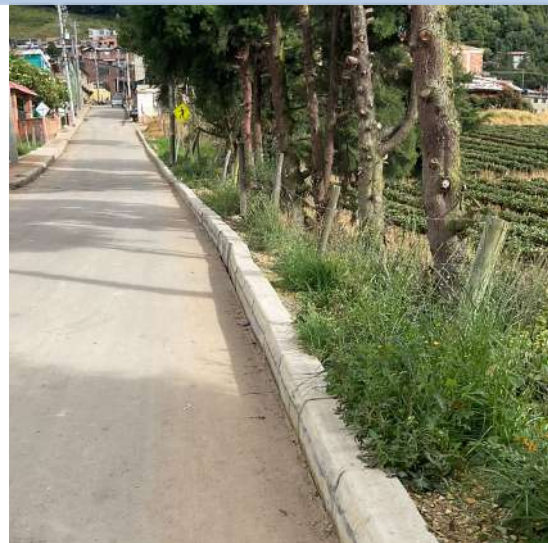
K+ 480 DESPRENDIMIENTO DE SARDINELES, DESPORTILLADOS, MANCHADOS, FISURADOS.
