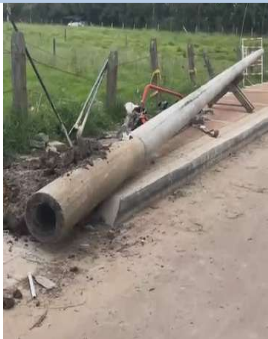
HUNDIMIENTO DE ANDÉN , LOSETA PREFABRICADA, ADOQUÍN, DESASEO..
