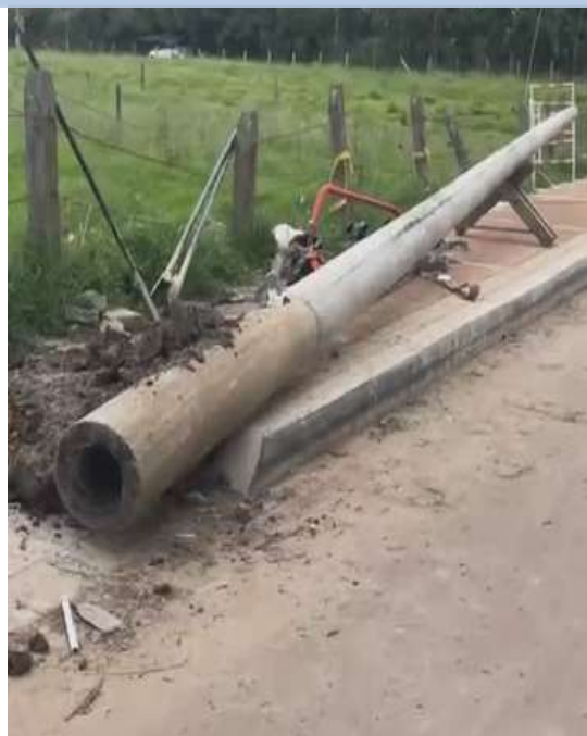
K+ 380 HUNDIMIENTO DE ANDÉN , LOSETA PREFABRICADA, ADOQUÍN, DESASEO..
