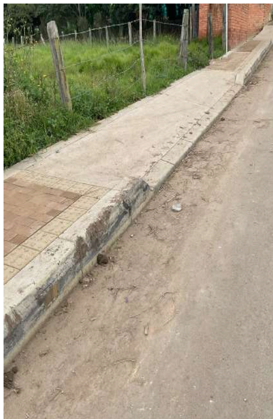
SARDINELES, DESPORTILLADOS, MANCHADOS, FISURADOS
