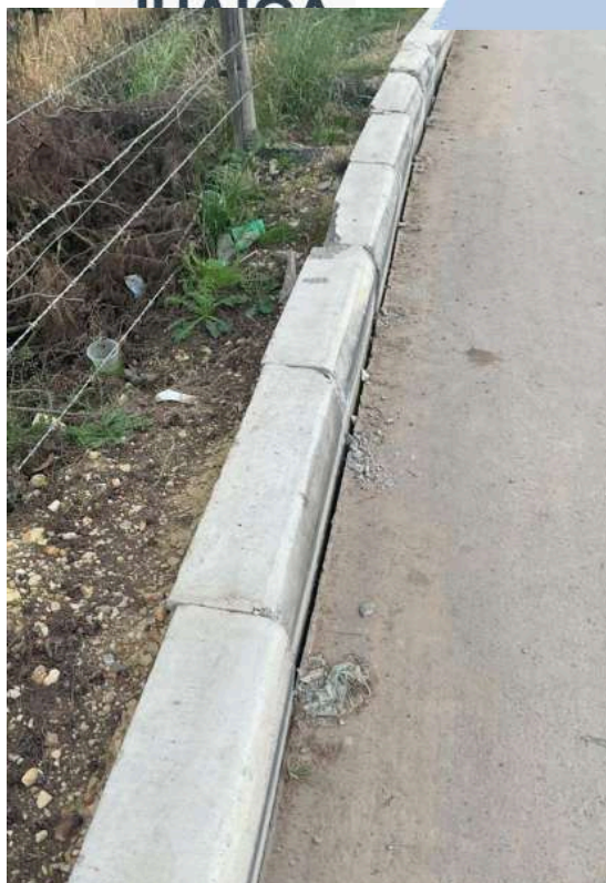
K+500 COSTADO NORTE DESALINEO SARDINELES, DESPORTILLADOS, MANCHADOS, FISURADOS
