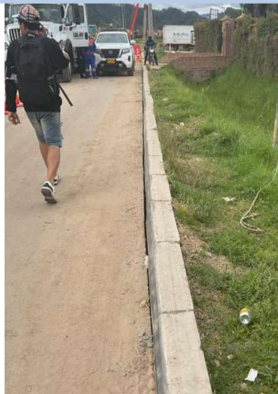
K+ 390 COSTADO SUR DESALINEO SARDINELES, DESPORTILLADOS, MANCHADOS, FISURADOS
