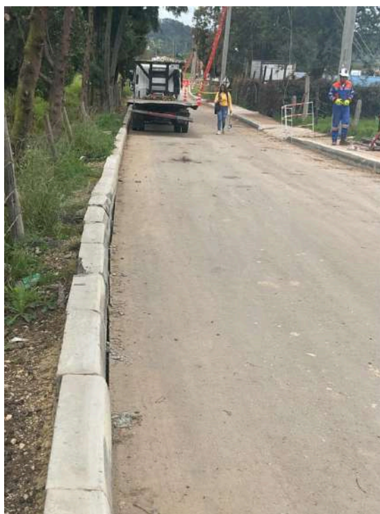
K+450 NORTE DESALINEO SARDINELES, DESPORTILLADOS, MANCHADOS, FISURADOS
