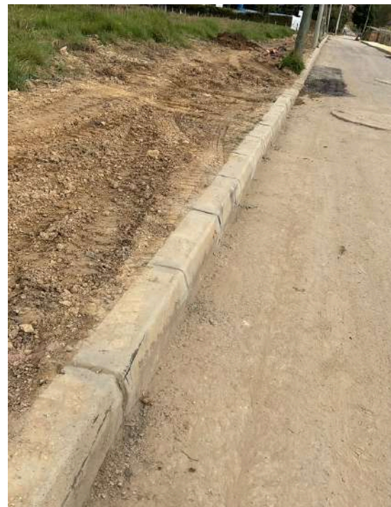
K+ 240 COSTADO SUR DESPRENDIMIENTO DE SARDINELES, DESPORTILLADOS, MANCHADOS, FISURADOS
