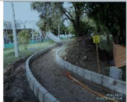
CORDONERÍA EN PISTA DE TROTE COSTADO SUR ORIENTAL
