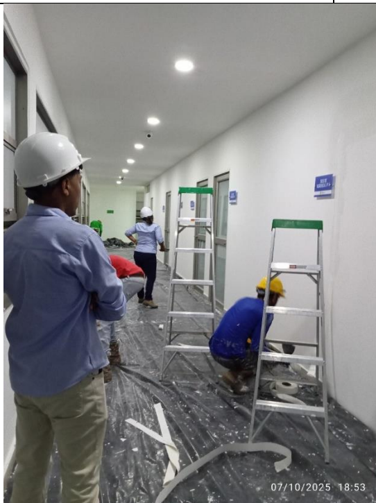
REVISIÓN DE ACABADOS DE PINTURA VINILO BLANCO EN MUROS EN FRENTE DEL PALACIO DE JUSTICIA DE COROZAL
