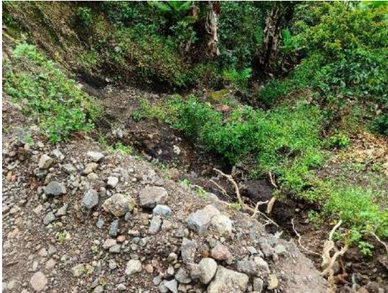
Fig. 1: Perdida de talud de la vía.
