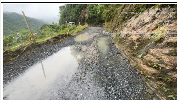
PR 43+600 RUTA 6002, VISITA TÉCNICA SITIO CRÍTICO POR PÉRDIDA DE BANCA.
