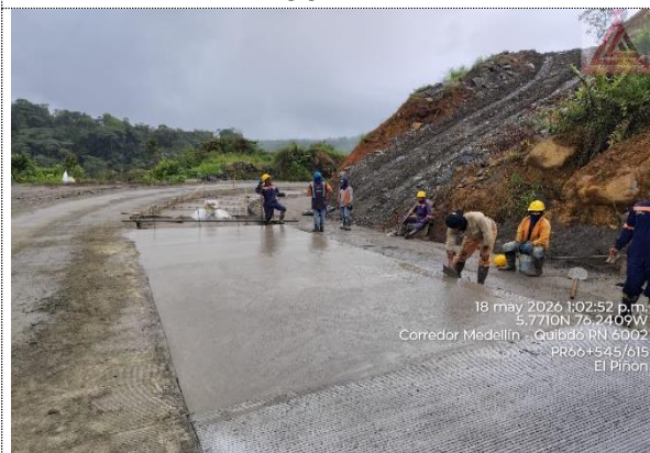
PR66+545/615 Ruta 6002, Fundición placa pavimento carril izquierdo.
