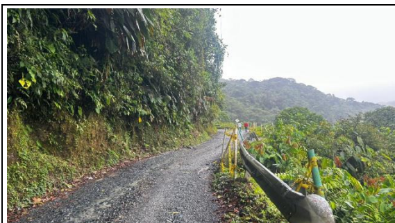
PR 43+650 RUTA 6002, VISITA TÉCNICA SITIO CRÍTICO POR PÉRDIDA DE BANCA.
