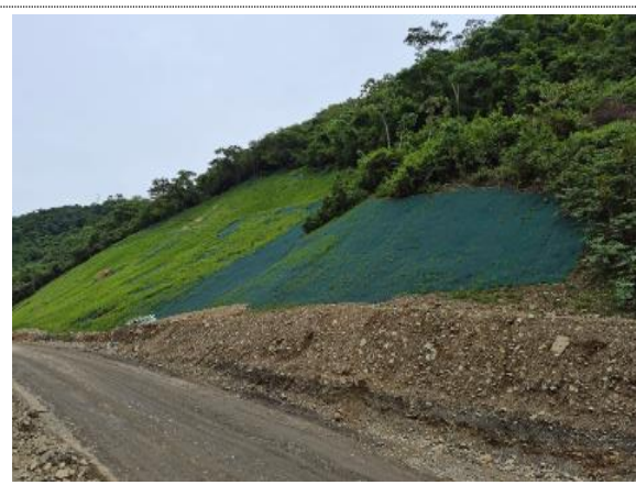
PR 36 - REVEGETALIZACIÓN DE TALUD SIN PRENDIMIENTO AL 100%
