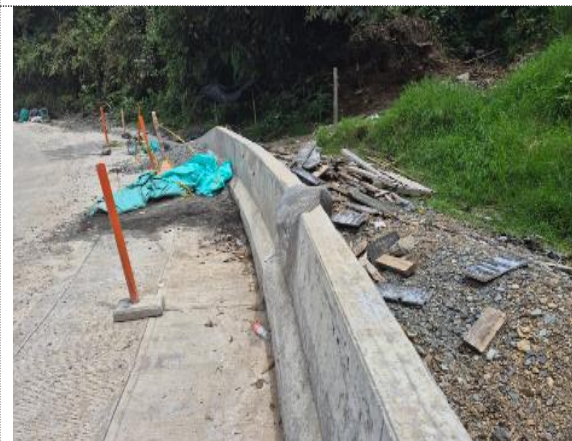
PR 98 - ORDEN Y ASEO DEFICIENTE EN FRENTE DE TRABAJO
