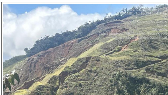
PR95+000 RUTA 6002, FALLA GEOLOGICA EN TALUD.
