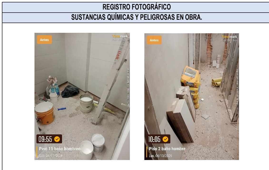
Ilustración 7. Sustancias químicas y peligrosas en Obra.
