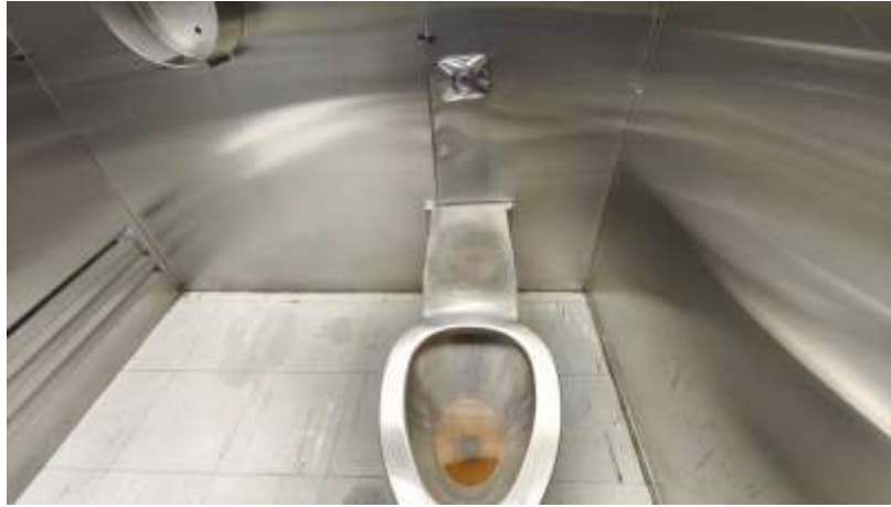
Foto # 2. Los sanitarios están fallando y los sistemas de agua
