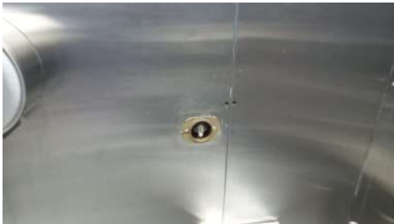
Foto # 1 . Plus en mal estado de los orinales y los sanitarios
