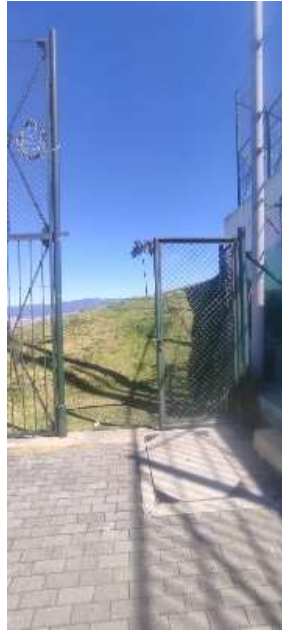
Foto # 8 Puerta de la cancha # 1 está deteriorada
