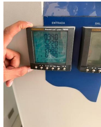
Display de salida Dañado
