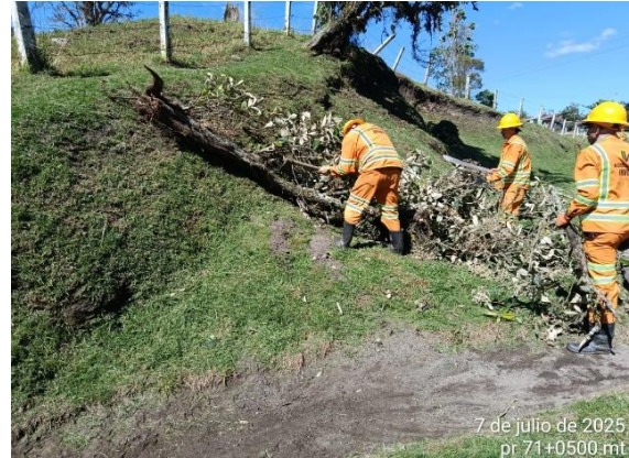
CARRETERA: OTANCHE - CHIQUINQUIRÁ (6007) SITIO: PR71+0500 DESCRIPCIÓN: RETIRO ARBOLES PELIGRO CAIDA FECHA: 07 de julio de 2025
