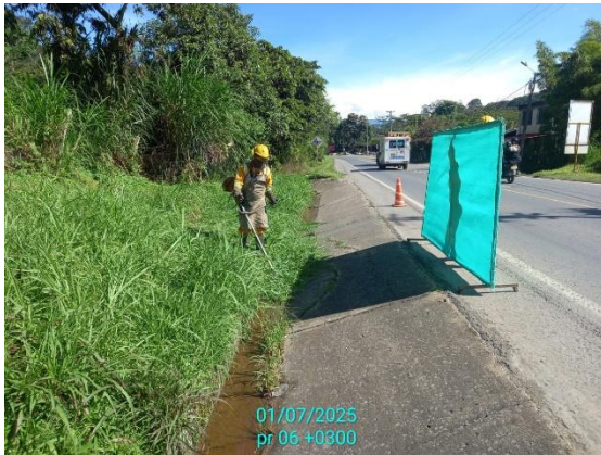
CARRETERA: BARBOSA-TUNJA (6209) SITIO: PR06+0300 DESCRIPCIÓN: ROCERÍA FECHA: 01 de julio de 2025
