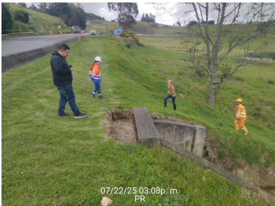
CARRETERA: BARBOSA-TUNJA(6209) SITIO: PR51+0400 DESCRIPCIÓN: VISITA TECNICA ASESORES INVIAS DESLIZAMIENTOS FECHA: 22 de julio de 2025
