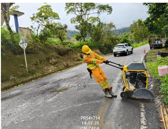
CARRETERA: OTANCHE - CHIQUINQUIRÁ (6007) SITIO: PR54+0714 DESCRIPCIÓN: CORTE PAVIMENTO FECHA: 14 de julio de 2025
