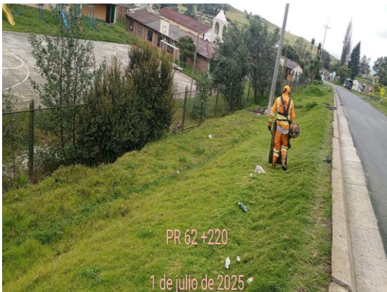
CARRETERA: BARBOSA-TUNJA (6209) SITIO: PR62+0220 DESCRIPCIÓN: ROCERÍA FECHA: 01 de julio de 2025
