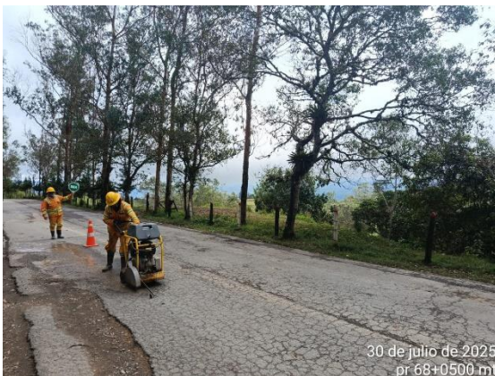
CARRETERA: OTANCHE - CHIQUINQUIRA (6007) SITIO: PR68+0500 DESCRIPCIÓN: CORTE PAVIMENTO FECHA: 30 de julio de 2025
