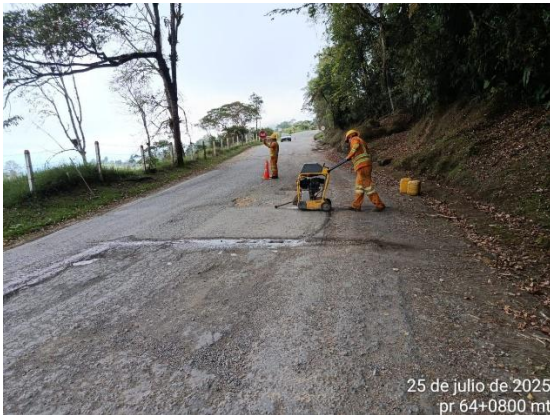
CARRETERA: OTANCHE - CHIQUINQUIRÁ (6007) SITIO: PR64+0800 DESCRIPCIÓN: CORTE PAVIMENTO FECHA: 25 de julio de 2025
