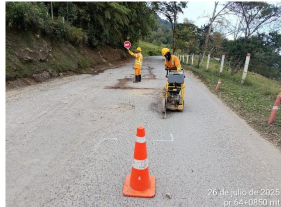
CARRETERA: OTANCHE - CHIQUINQUIRÁ (6007) SITIO: PR64+0850 DESCRIPCIÓN: CORTE PAVIMENTO FECHA: 26 de julio de 2025
