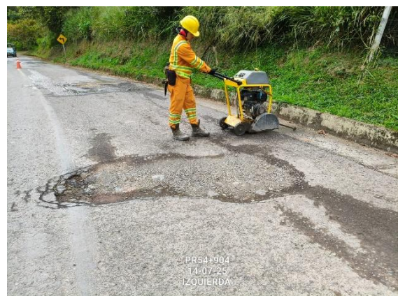
CARRETERA: OTANCHE - CHIQUINQUIRÁ (6007) SITIO: PR54+0904 DESCRIPCIÓN: CORTE PAVIMENTO FECHA: 14 de julio de 2025
