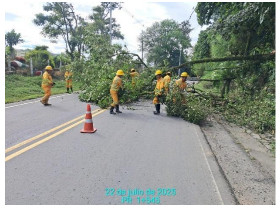
CARRETERA: BARBOSA-TUNJA (6209) SITIO: PR01+0545 DESCRIPCIÓN: RETIRO DE ARBOL CON PELIGRO DE CAIDA FECHA: 22 de julio de 2025
