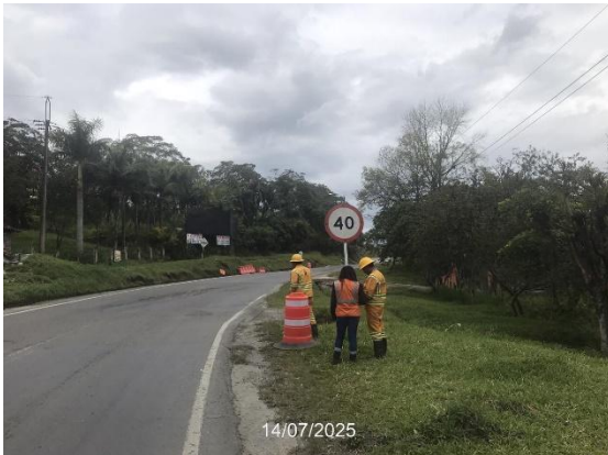
CARRETERA: BARBOSA - TUNJA (6209) SITIO: PR09+0450 DESCRIPCIÓN: SUPERVISIÓN SEÑALIZACIÓN PREVENTIVA DERRUMBE FECHA: 14 de julio de 2025
