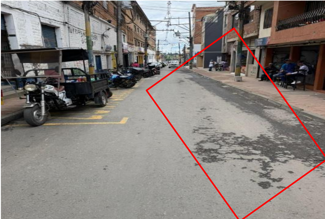
Ilustración 3 hundimiento costado en la vía
