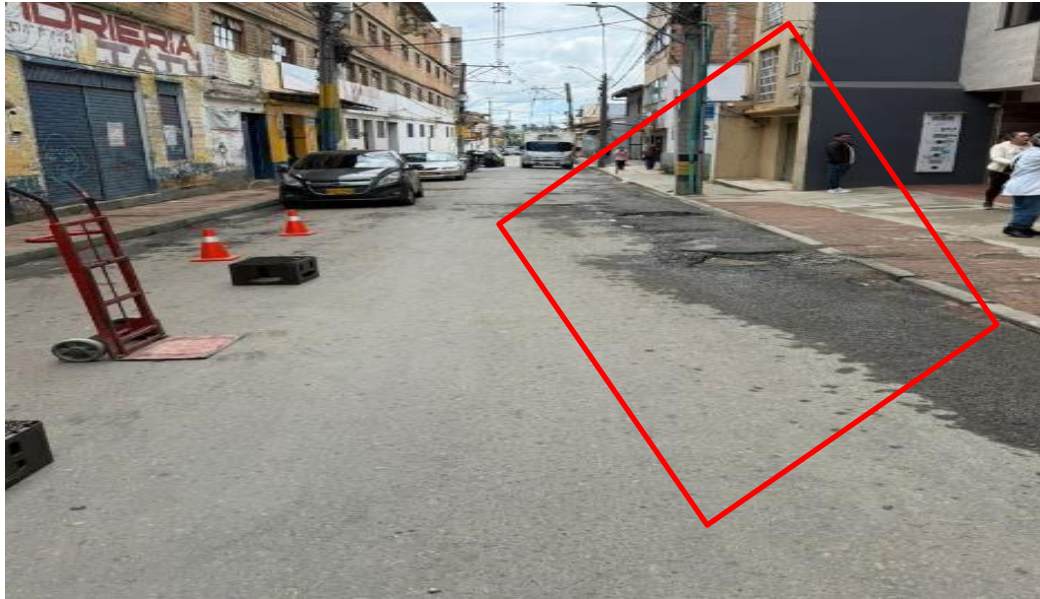
Ilustración 4 baches en el costado de la vía
