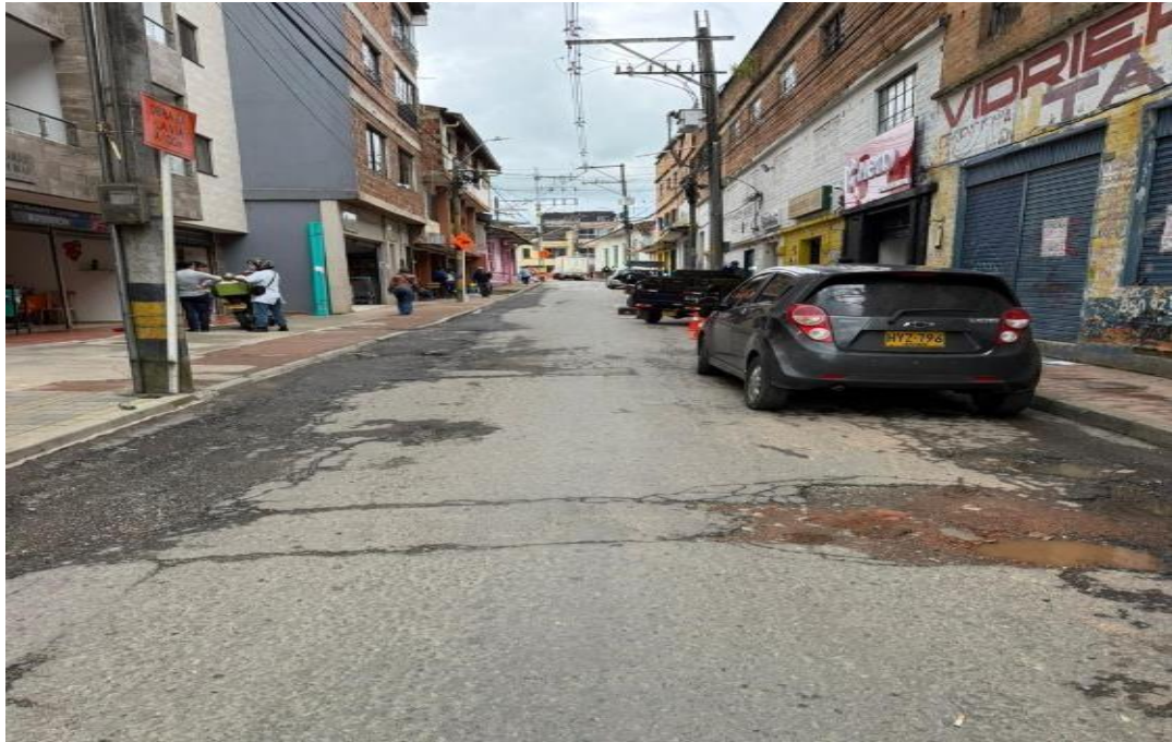
Ilustración 2 alto deterioro de la vía con grietas ,hundimiento y piel de cocodrilo
