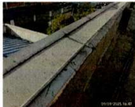
Detalle de las juntas en Alucobond con evidencia de filtraciones. Autoría propia, 2025
