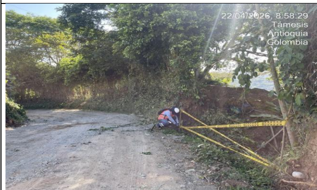
Foto 41. Señalización de puntos críticos
