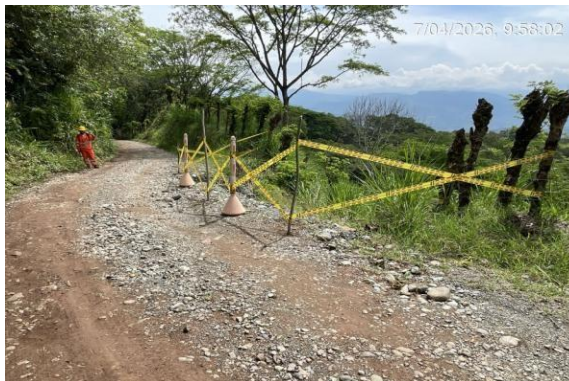
Foto 28. Señalización de puntos críticos PR 0+600.
