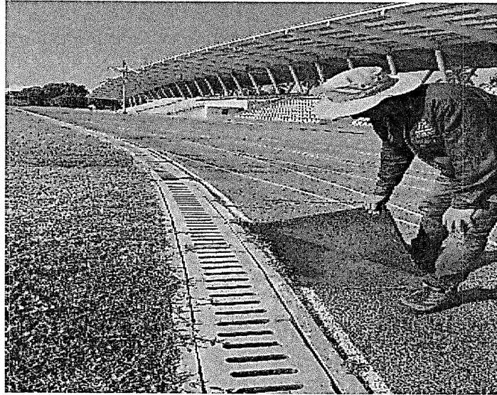
Imagen6. Inspección visual y manual. Imagen tomada del informe de INFORME TÉCNICO – JUSTIFICACIÓN DE REPOSICIÓN TOTAL DE PISTA DE ATLETISMO. Localización: Pista de atletismo ENAP
