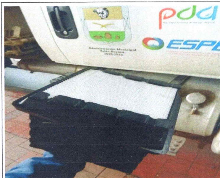
SUMINISTRO DE FILTRO DE AIRE EXTERNO
