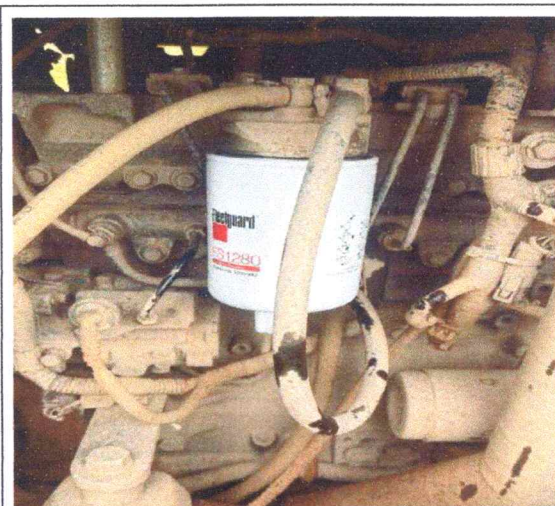
SUMINISTRO FILTRO COMBUSTIBLE
