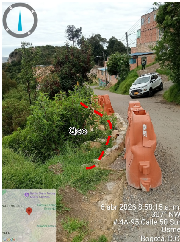
Figura 33. deslizamiento rotacional polígono 1
