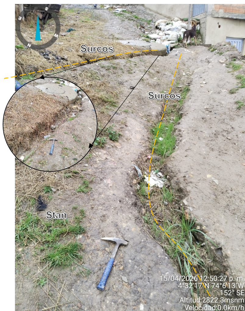
Figura 49. Surcos generados por escorrentías
