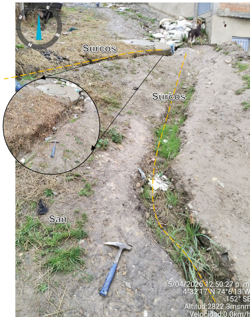
Figura 32. Surcos generados por escorrentías
