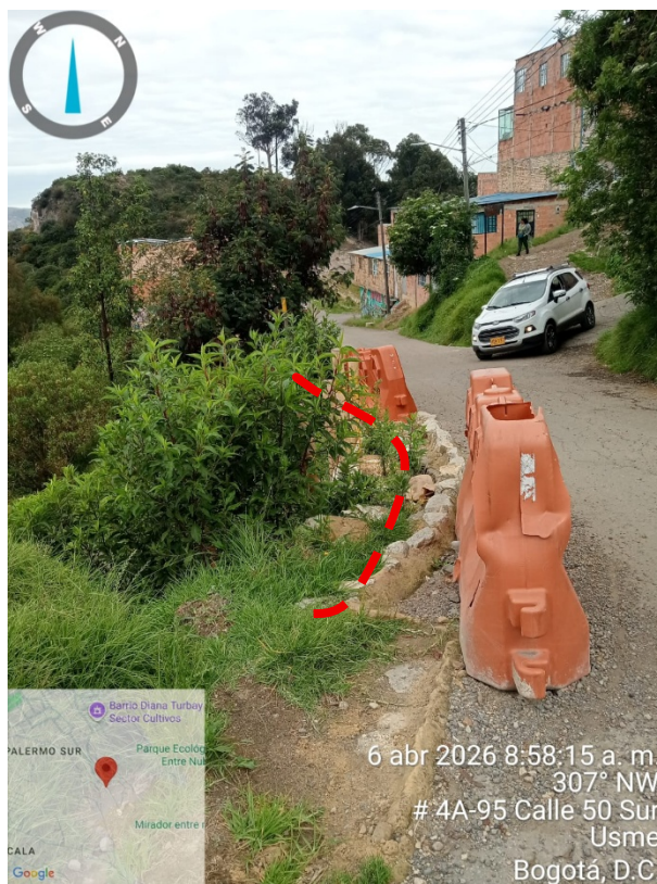
Figura 50. deslizamiento rotacional polígono 1
