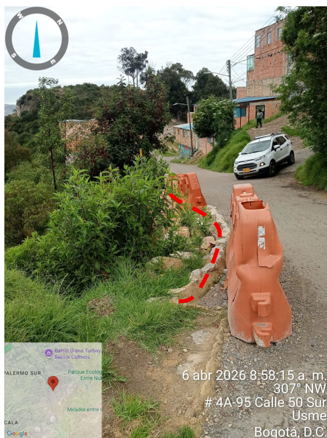
Figura 9. Sitio crítico polígono 1
