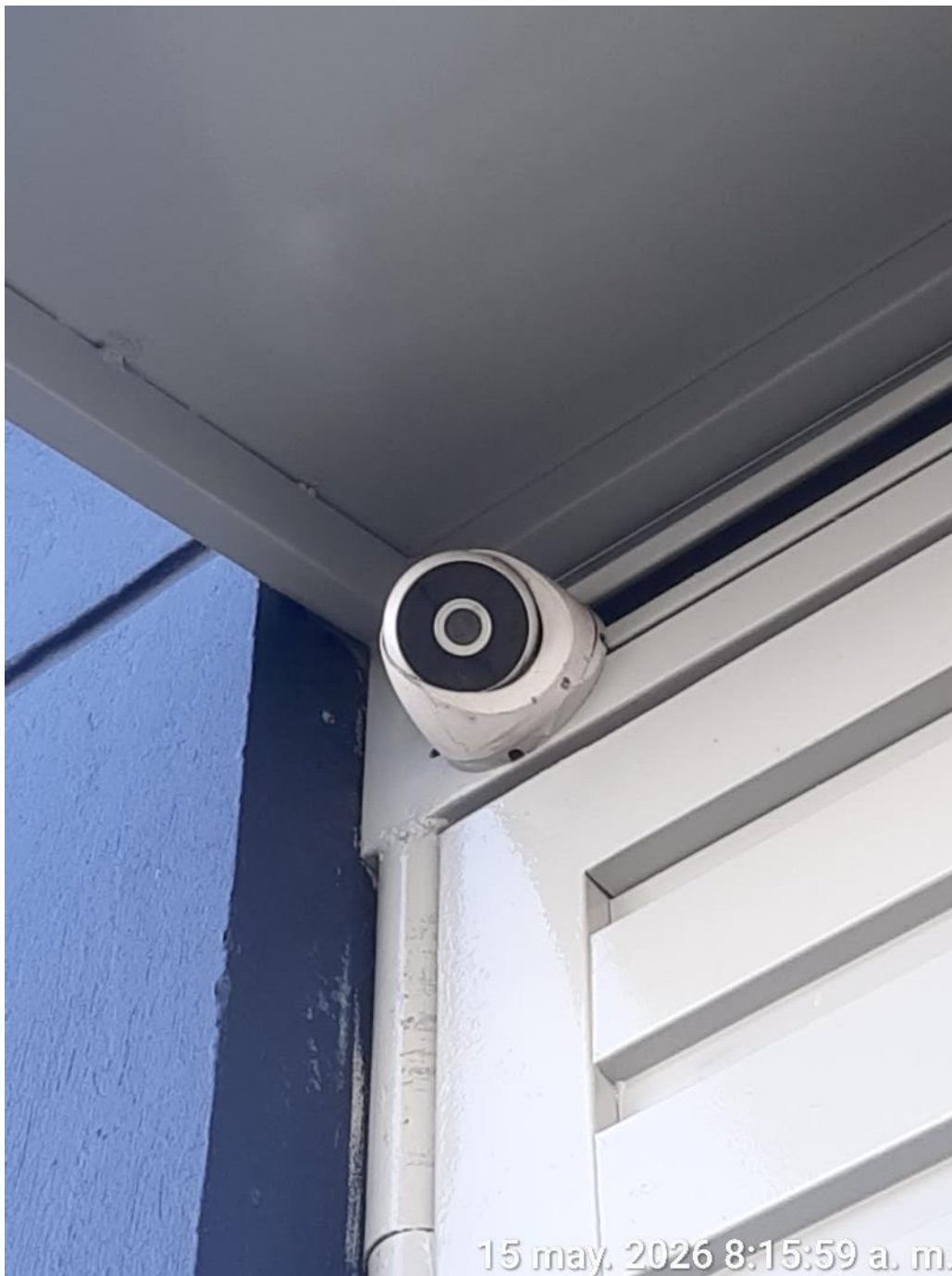
Foto 20. Verificación de los sistemas de seguridad (cámara de seguridad), en cumplimiento de la obligación 15 del contrato.
