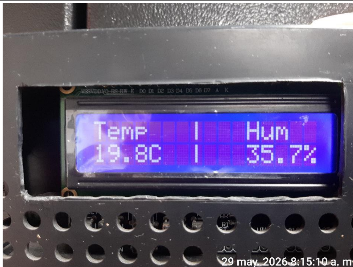
Foto 13. Detalle de lectura de humedad relativa de 35.7% y temperatura de 19.8°C para soporte medio óptico durante la visita del 29 de mayo de 2026, la cual está de conformidad con lo estipulado en el numeral 4.2. del Anexo del contrato.
