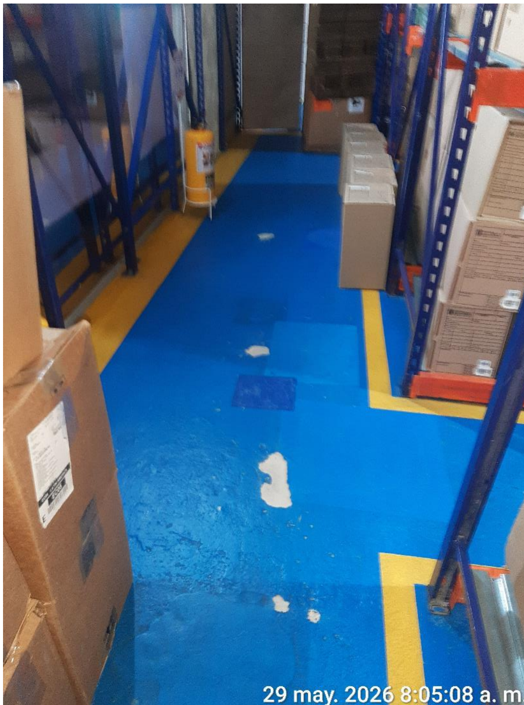
Foto 1. Piso a la entrada a la bodega de archivo sin arreglo locativo, afectando las obligaciones 1, 9 y 16 del Anexo No 1 del contrato..
