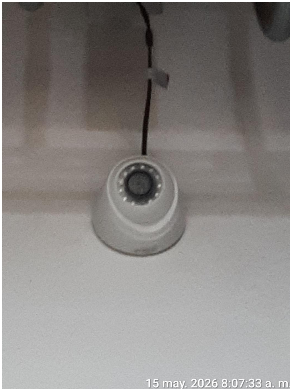
Foto 14. Verificación de los sistemas de seguridad (cámara de seguridad), en cumplimiento de la obligación 15 del contrato.
