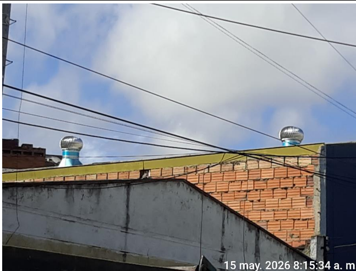
Foto 11. Vista externa de los extractores eólicos.
