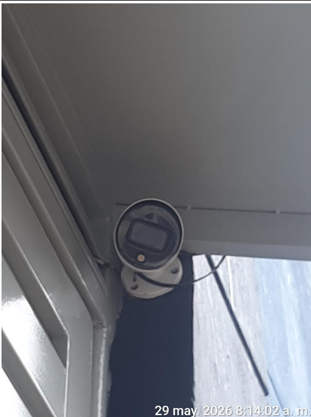
Foto 21. Verificación de los sistemas de seguridad (cámara de seguridad), en cumplimiento de la obligación 15 del contrato.
