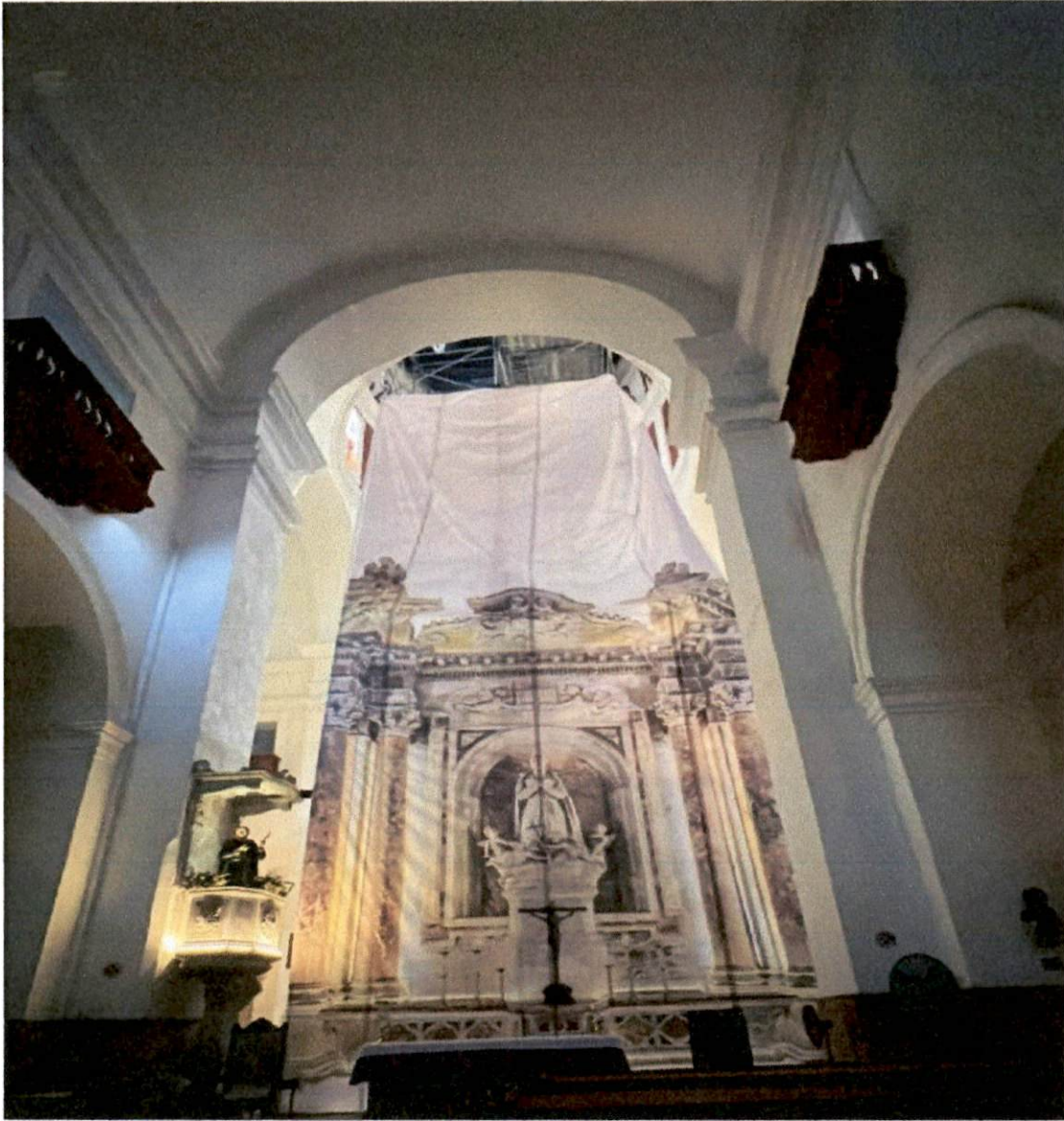
Ilustración 11: Realización de IMPRESIÓN Y MONTAJE FOTOGRAFICO
