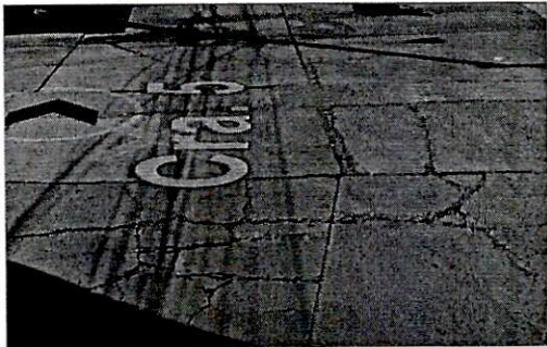
Imagen 15. Asentamientos diferenciales parciales en la mayoría de las losas de concreto
