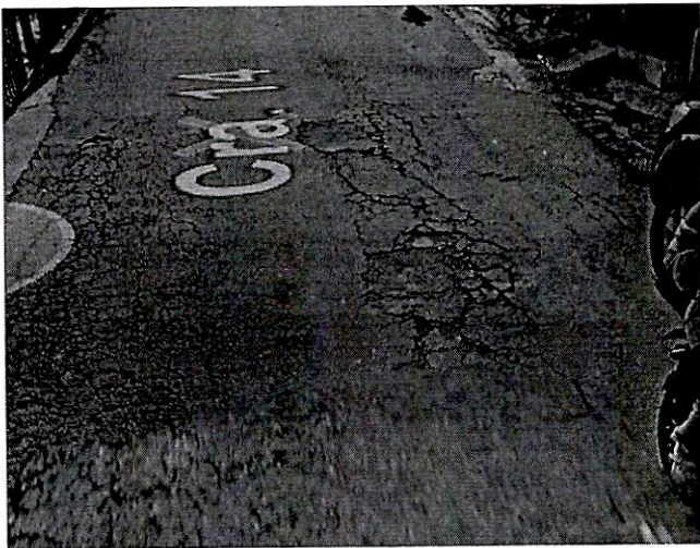
Imagen 17. Deterioro significativo en la capa de rodadura, evidenciado por desgaste superficial, presencia de fisuración tipo piel de cocodrilo y agrietamientos
