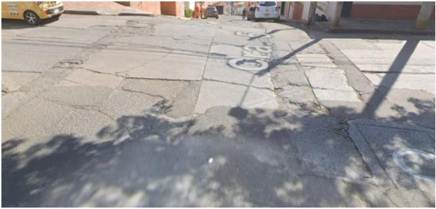
Imagen 14. Agrietamientos en losas de concreto rígido cerca a la alcantarilla de red sanitaria.
