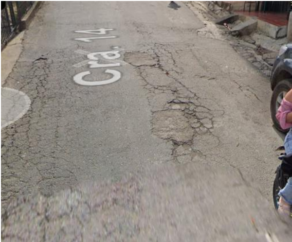
Imagen 18. Deterioro significativo en la capa de rodadura, evidenciado por desgaste superficial, presencia de fisuración tipo piel de cocodrilo y agrietamientos
