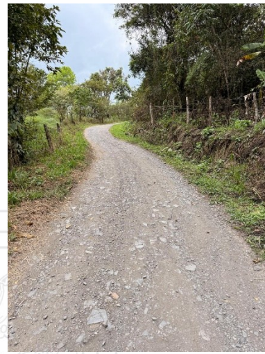
Punto Final K5+399 74°17'21.40"O 5°0'39.26"N Final sobrante del recebo presenta mal afirmado y compactado en varias zonas.
