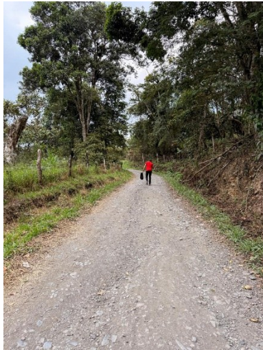
Punto intermedio K5+379 74°17'20.80"O 5°0'39.15"N, no tiene manejo de agua lluvia, desgaste en la carretera mal afirmado.
