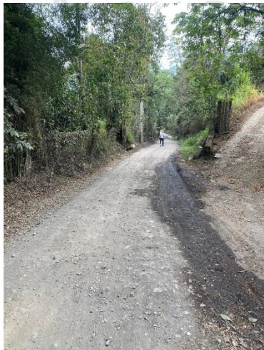
K2+737 74°16'53.90"W 4°59'11.20"N Punto inicial del tramo con una inclinación promedio del 16.4%.
