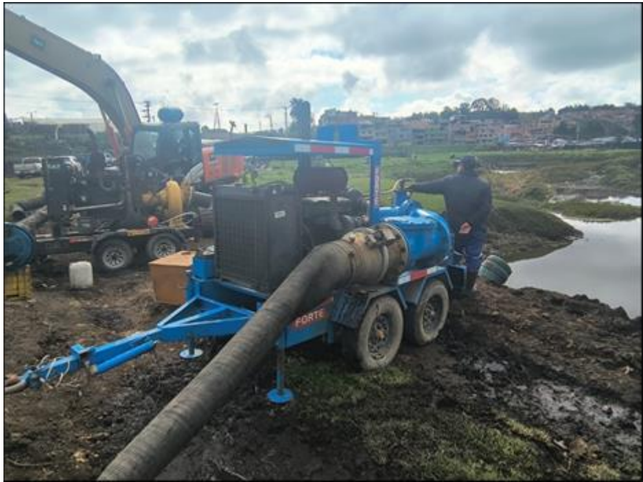
Fotografía 8. Equipo de bombeo en operación sobre remolque, dispuesto para extracción de agua acumulada desde el sector anegado.
