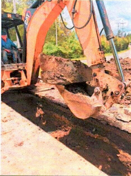
ROCA ENCONTRADA DENTRO DE LA TUBERIA DE CONCRETO
