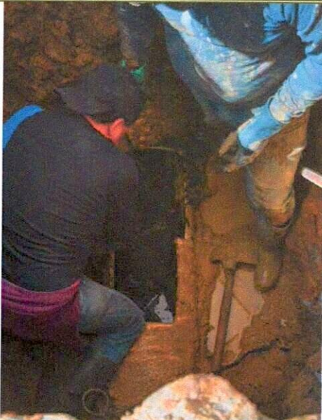
OBSTRUCCIÓN ENCONTRADA EN LA RED (Imagen 1)
