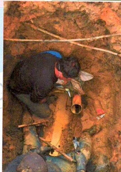
OBSTRUCCIÓN ENCONTRADA EN LA RED (Imagen 2)
